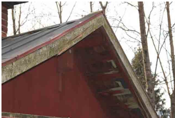
Vindskiva mot nordväst har spruckit.
