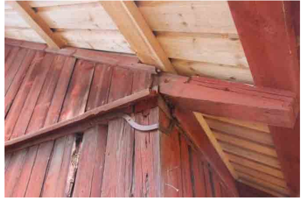
Bild t.h. Hörnen i stommen binds samman med järn. Enkelt utformade takfotstassar och nytt undertak. Små skador i panelen.
