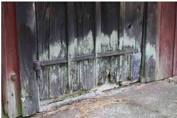
Bilden visar rötskadad del av dörr på södra fasaden.
