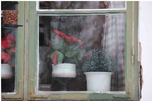
Bild t.v. fönster i renoveringsbehov.
