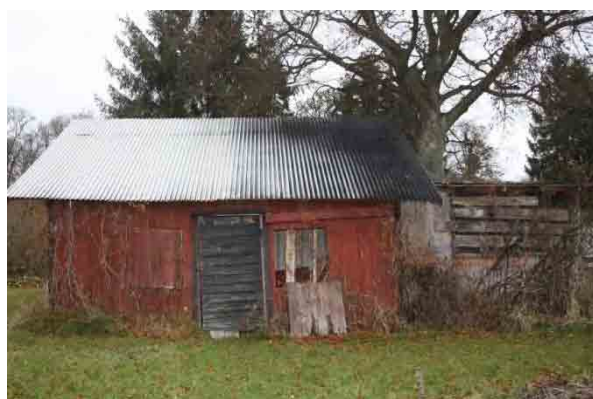
Bild t.h. Södra fasaden, väggpartierna på sidorna om dörren lutar in mot dörren.
