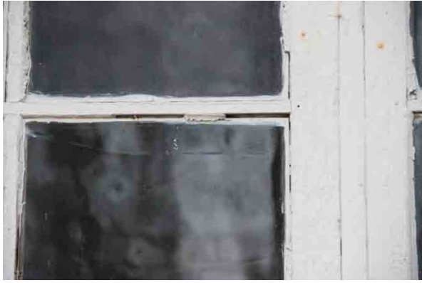
Bild t.v. fönster i behov av renovering, munblåst glas.
