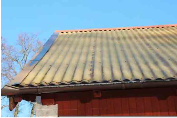
Bild t.v. takplåt med flagnande och urblekt färg.
