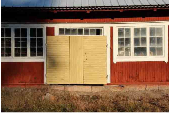
Bild t.v. port på södra fasaden, avväxling behöver ses över.
