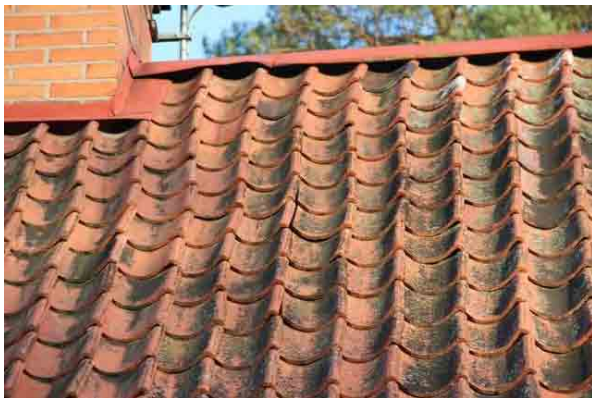
Bild t.v. västra takfallet, sprigor mellan pannor. Bild t.h. västra takfallet, växtlighet i hängränna.
