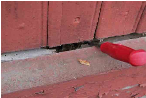
Västra delen av norra gaveln. Syllen är avsågad vid öppningen. Syllen är angripen av skadeinsekter och saknar bärighet. Fotbräda har släppt.
