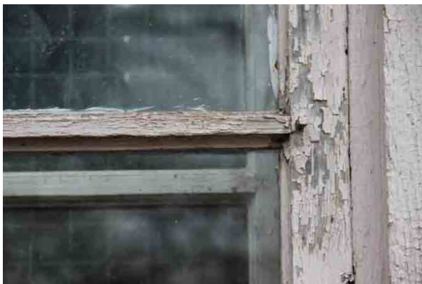
Fönstren i behov av renovering.
