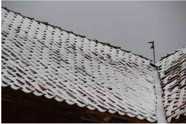
Vindflöjel har rostat sönder.
