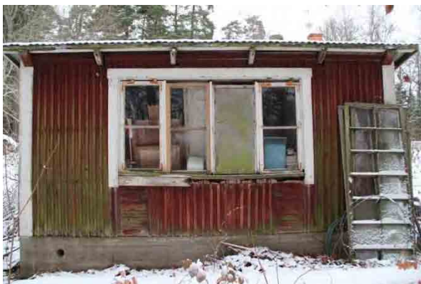
Bild t.v. södra fasaden, skador i väggen under fönster.
