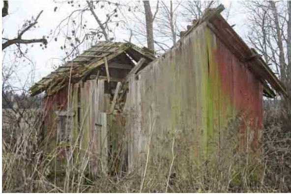
Förfallen byggnad, nr 10.
