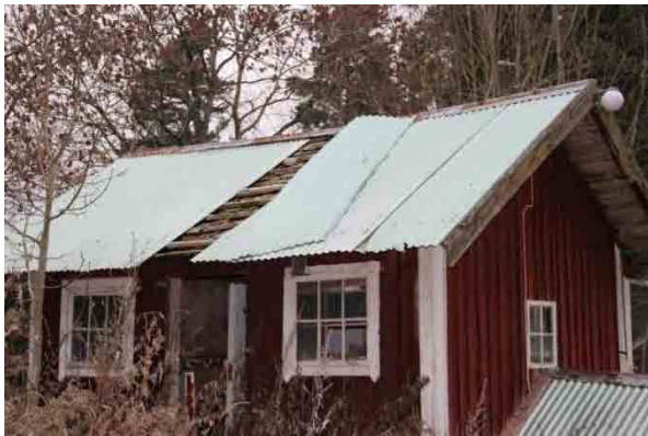
Bild t.v. Byggnaden sedd från sydöst med saknad takplåt.
