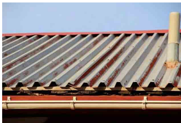
Bild t.h. stålplåt med bortnött färg. Under plåten syns ett äldre skikt av vatthyvlade takbrädor.
