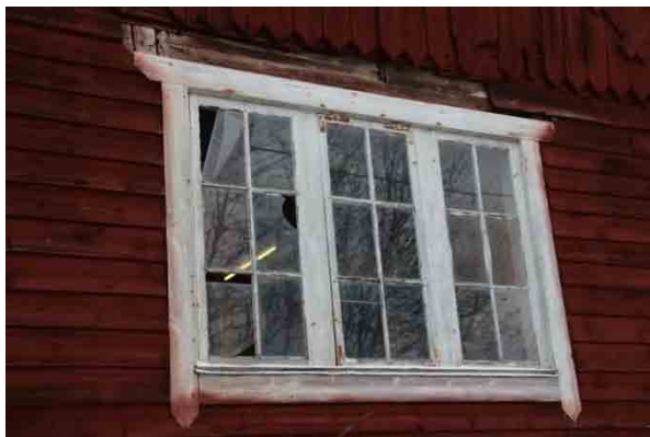
Bild t.v. fönster i behov av renovering, västra gaveln.
