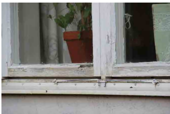
Bild t.v. fönster i behov av renovering.
