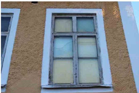
Bild t.v. fönster i behov av renovering.
