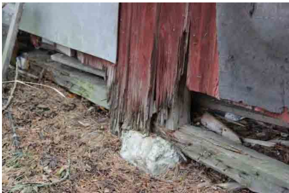
Bild t.v. Rötskador i syll och stolpe på byggnadens västra sida
