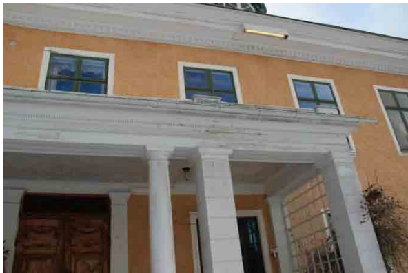
Bild t.v. Pelaruppburet entréparti i väster med färgflagning.
