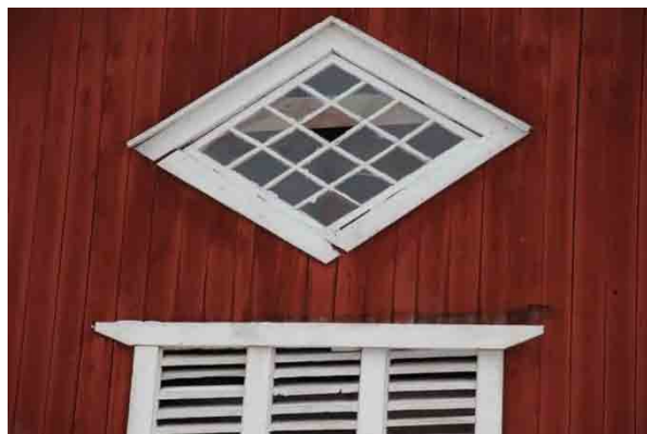
Bild t.v. trasigt glas i fönster och foder till ventilation har släppt.
