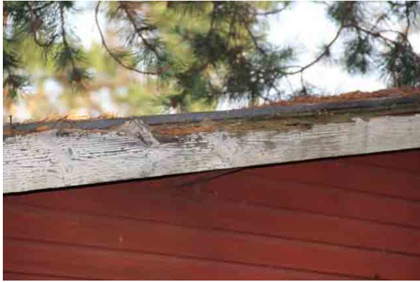
Skadad vindskiva, västra gaveln.
