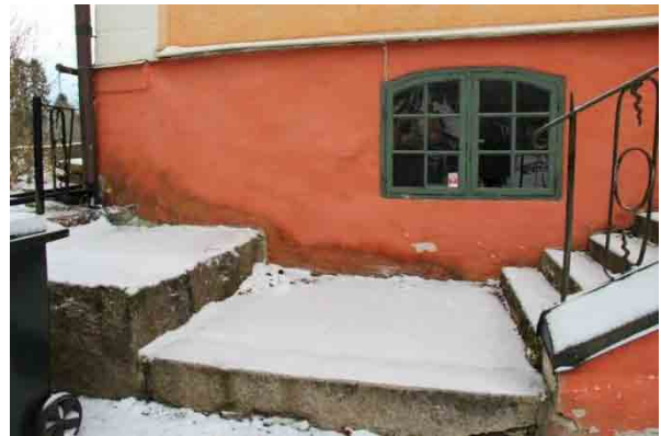
Bild t.h. Fukt samlas på vilplan vid trappa och putsen skadas på grunden på norra fasadens östra del.
