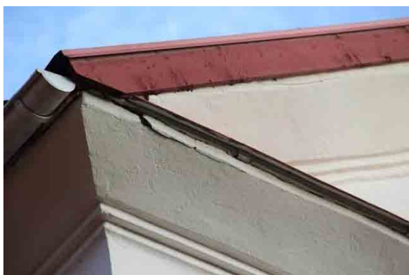
Bild t.v. sprickor i puts. Bild t.h. putsläpp.
