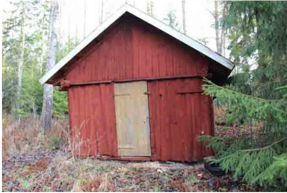
Bild t.v. Södra gaveln, byggnaden lutar åt väster.
