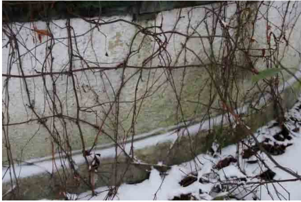
Bild t.v. algbildning p.g.a. fukt. Bild t.h. färgskikt spricker upp
