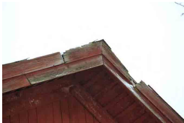
Bild t.v. skadade vindskivor i södra gaveln.
