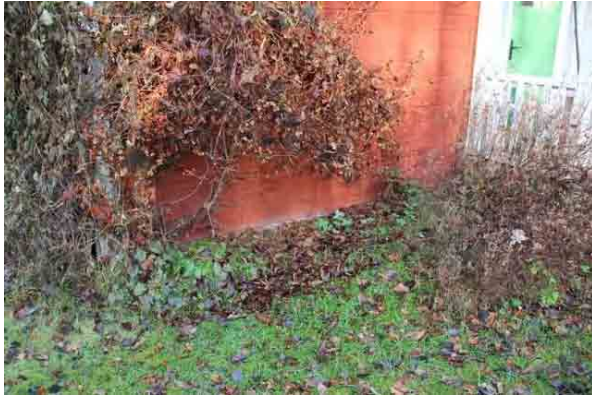
Bild t.v. hög marknivå intill del av sydöstra fasaden Bild t.h. takutsprång dippar ner sydöstra takfallet
