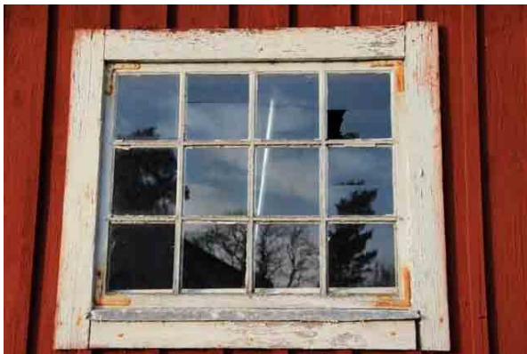
Fönster i behov av renovering.
