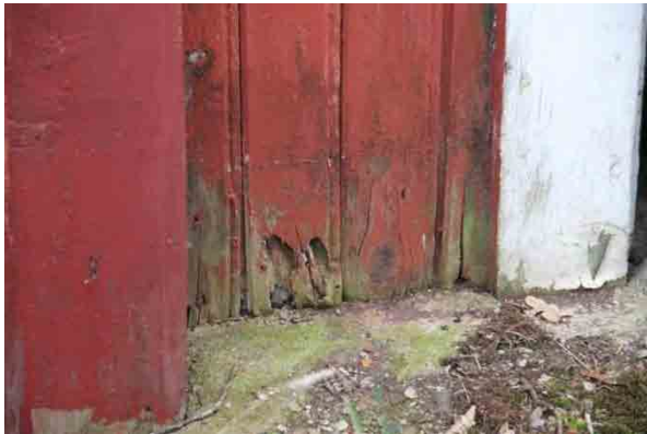
Bild t.v. skador i panel mot betong, västra fasaden.
