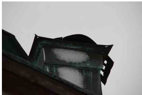
Bild t.v. svep över skorsten har skjunkit ner. Bild t.h. vindflöjel i behov av skyddsåtgärder.
