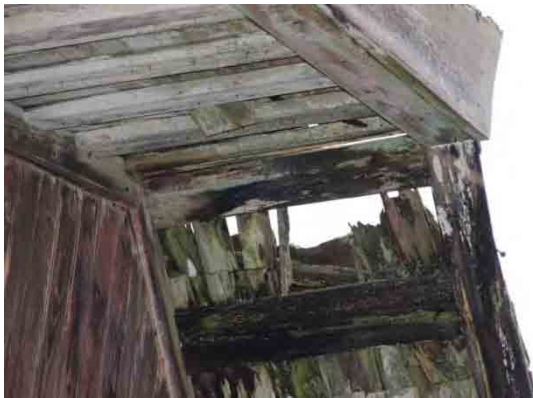
Bild t.v. stora skador i takutsprång mot nordväst.
