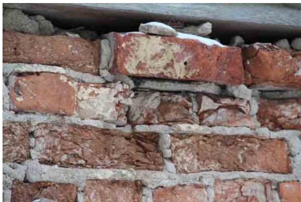
Bild t.v. frostsprängt tegel östra fasaden.
