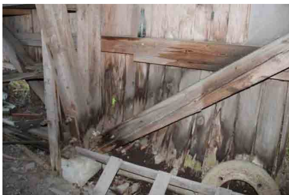
Bild t.v. rötskador i södra väggen. Bild t.h. rötskador i sydvästra hörnet.
