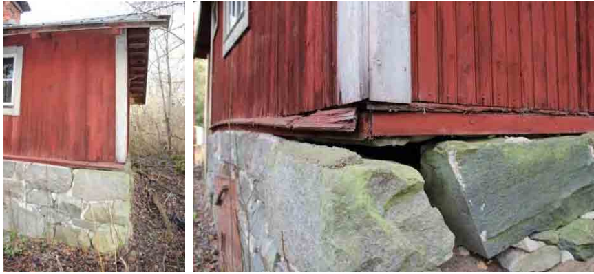
Bild t.v. och t.h. södra knuten, grunden kalvat och spruckit isär.
