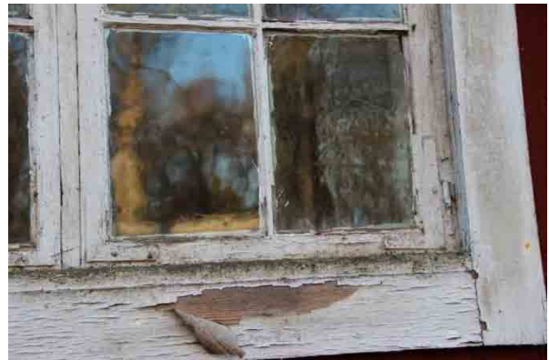
Bild t.h. fönster med mun blåst glas. Renoveringsbehov. Oklar färgtyp.
