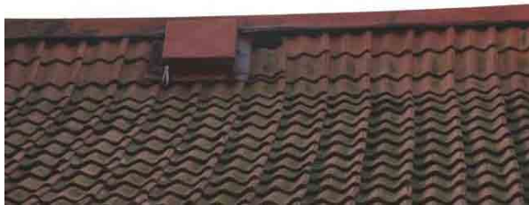
Bild t.v. östra takfallet, nedgliden panna. Bild t.h. fönster i behov av underhåll.
