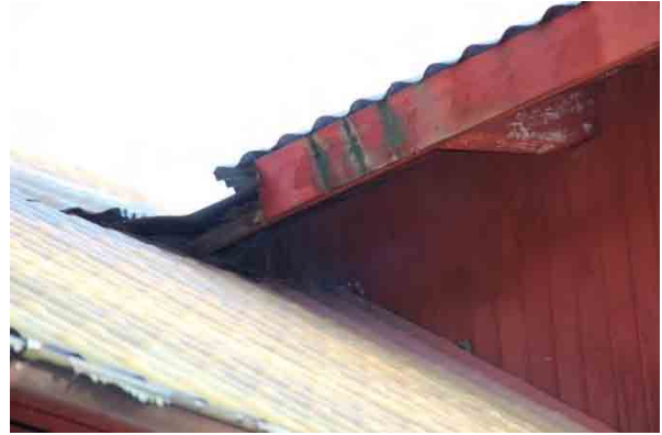
Bild t.h. risk för rötskada, plåt har ej tillräckligt utskjut över takfotsbräda.
