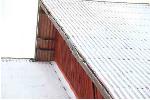
Bild t.v. rötskadad vindskiva, östra gaveln av stalden.
