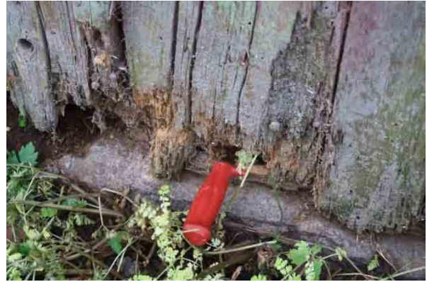
Bild t.h. norra fasaden, panel och syll är kraftigt rötskadade, hele knivbladet går in i syllen.
