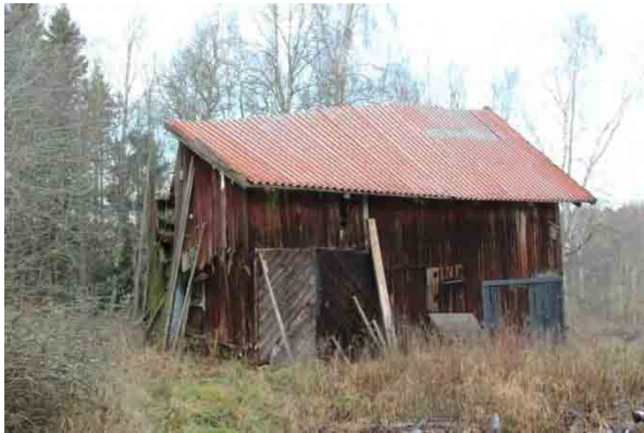
Förfallen byggnad nr 55.
