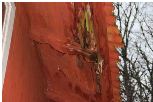
Bild t.v. och bild t.h. södra takfallet. Skador i takutsprång.
