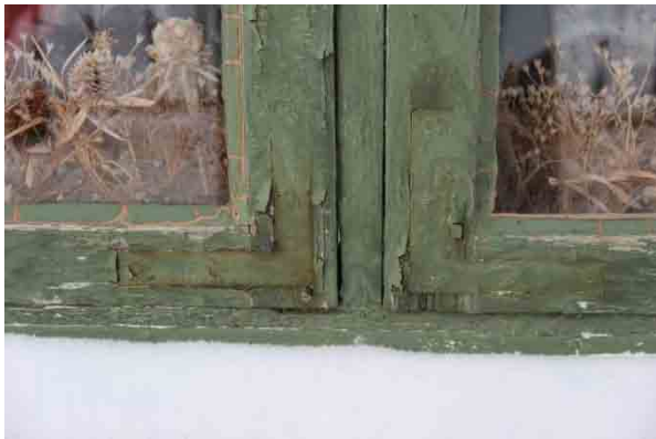
Bild t.v. Fönster i behov av underhåll, östra fasaden.
