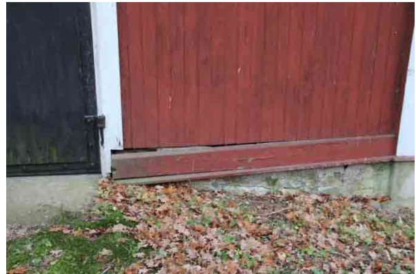
Bild t.h. västra delen av norra gaveln. Betonggolv har gjutits mot timret. Syllen är avsågad vid öppningen. Syllen är angripen av skadeinsekter och saknar bärighet. Fotbräda har släppt.
