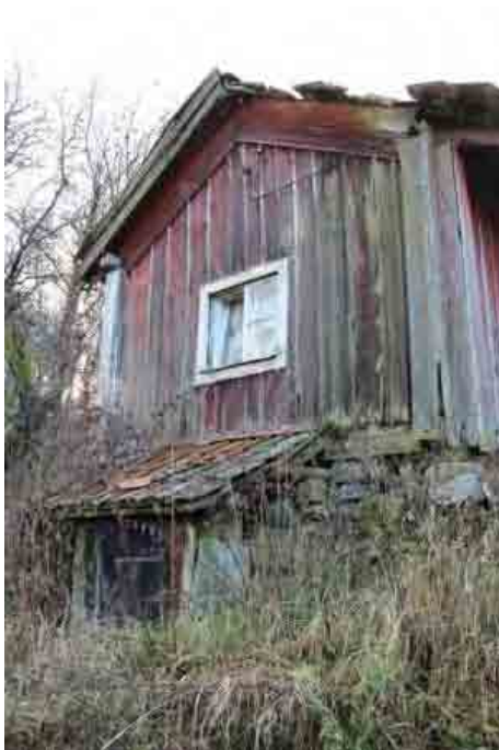
Bild t.v. nordöstra gaveln med omfattande skador.
