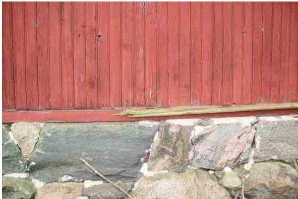
Bild t.v. sydöstra gaveln, rötskadad vattbräda.
