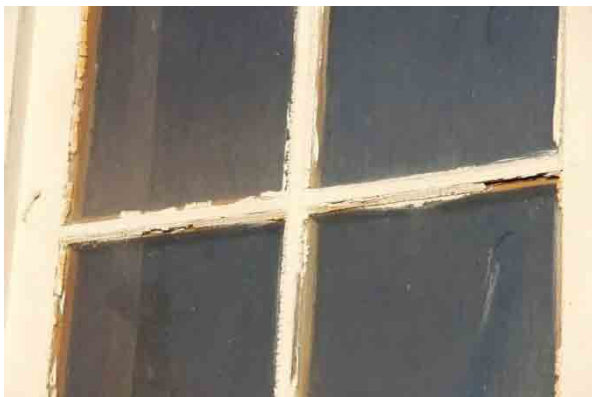
Bild t.v. fönster i behov av renovering.
