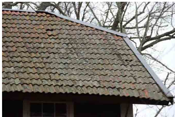
Bild t.v. västra takfallet. Skador i tegeltaket.
