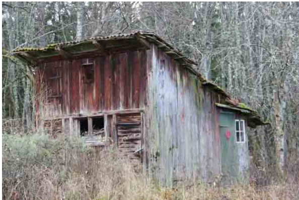
Förfallen byggnad nr 56.
