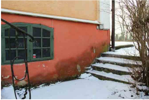
Bild t.v. Fukt i grunden på södra gaveln.
