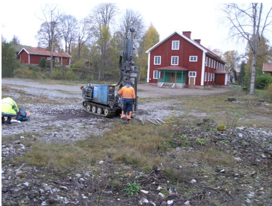
Figur 2. Arbetsbild. Provboring i den igenfyllda ytan mellan Makalös-schaktet och Sandrymningen. Fotograferat av Anna Libammer, oktober 2006.
