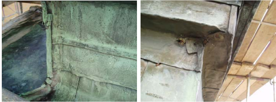
Figur 18. Svängda falsar har spruckit på grund av vindbelastning. Foto Oscar Mässing. Figur 19. Hål fanns i kopparplåten på flera ställen, exempelvis takfot. Foto Oscar Mässing.
