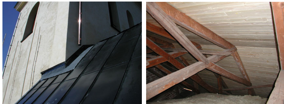
Figur 6. Avtäckning mellan långhustak och tornets takavvattning. Digitalfoto VLM.
