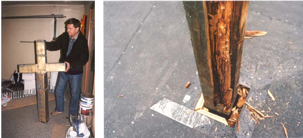
Figur 20, t.v. Nedtaget kors samt Gunnar Smedberg från Rörman plåt och ventilation. Foto: KM. Figur 21, t.h. Omfattande rötskador i korsstocken. Foto: KM.
