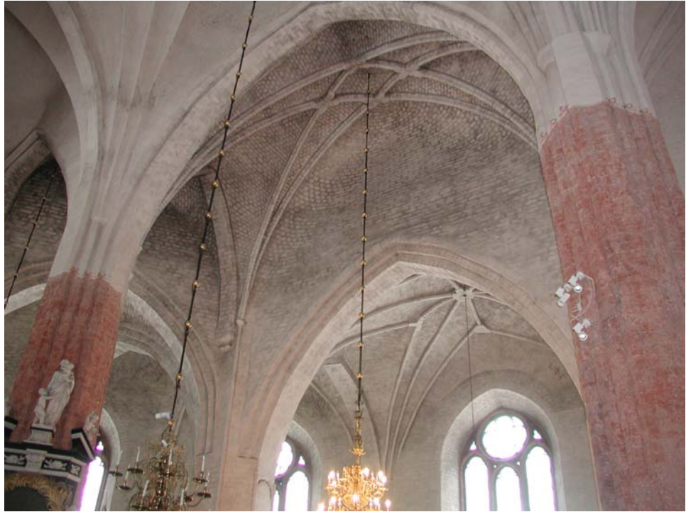
Figur 6. Valv 12 och 13 före rengöring.
