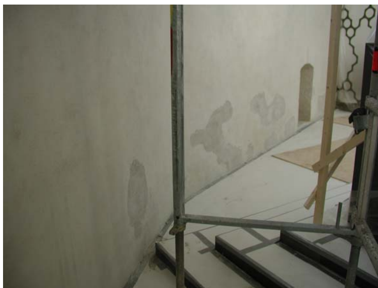
Figur 15. Mindre skador i putsen lagade på den östra väggen
