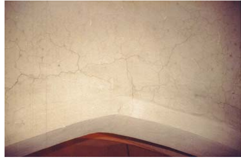
Figur 17 t.h. Sprickor i putsen valv 1. den gamla putsen vilar på en kant av KC-bruk från tidigare renoveringar.
