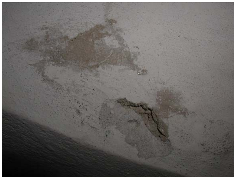
Figur 14. Mindre skada i putsen i valv 1 visar hur senare renoveringars hårdare puts håller kvar den äldre putsen.
