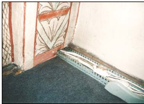
Figur 12. Äldre eldragning från läktaren mot vinden.
