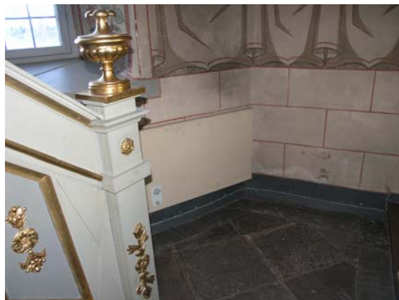
Figur 8. Äldre radiator i koret, bakom predikstol.
