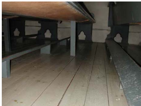
Figur 20. Bänkarnas undersidor före renoveringen.
