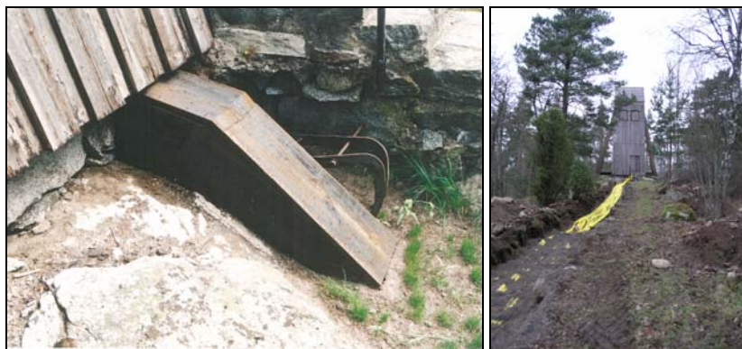
Figur 24. Inbyggnad för kablarna där rören går upp till marken vid klockstapeln.
