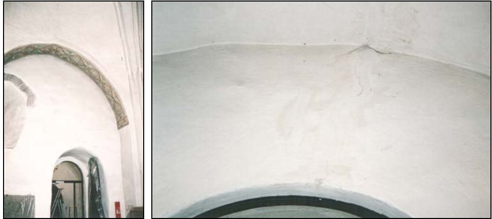
Figur 17. Spricka i puts över sydingången. Foto: Helén Sjökvist.
