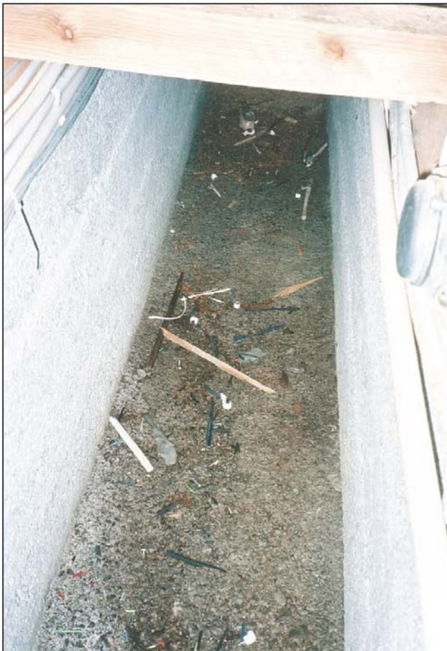
Figur 13. Kulvert under Harakers kyrkogolv. Den har uppenbarligen inte använts för kablar. Dessa är fastsatta i golvet reglar. (Foto U. Alström).
