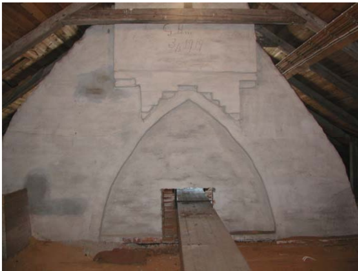
Figur 12. Murstock på vinden.
