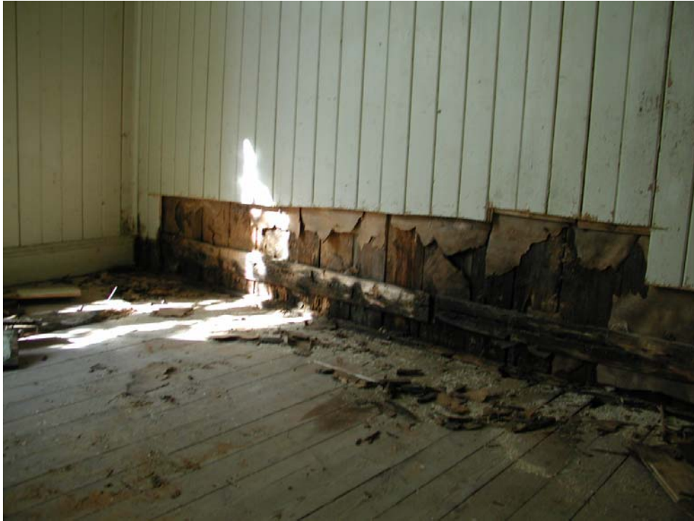
Figur 28. Rötskador i panel i rum som gränsar till det gamla tvättrummet. Panelen plockades ned för att åtgärda skador i väggen. Därefter återmonterades panelen samt kompletterades där rötskadorna varit omfattande.
