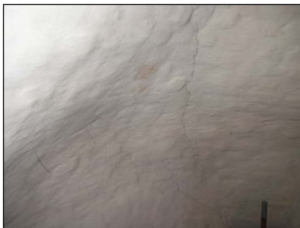
Figur 12. Sprickbildning i valvputsen i travé 4 före lavering. Foto: Helén Sjökvist.
