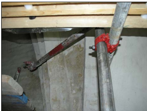
Figur 8. Omfattande missfärgat parti i travé 2, sydvästra svickeln. Foto: Helén Sjökvist.
