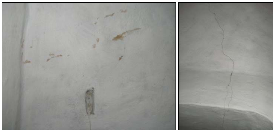
Figur 9. Travé 3, missfärgningar i puts i nordvästra hörnet strax över skvallerhålet. Foto: Helén Sjökvist.
