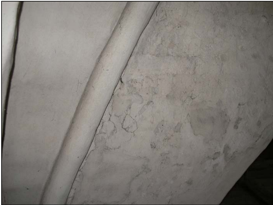
Figur 13. Travé 4, äldre puts i gördelbågen mot söder. Foto: Helén Sjökvist.
