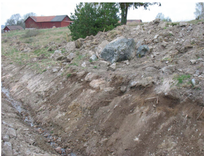
Figur 2. Schaktkanten där husgrunden var synlig. Kvistberga gård syns i bakgrunden. Foto fr SÖ J. Åhlström
