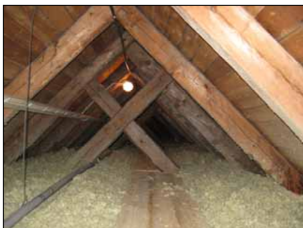
Figur 4. Vind och takstol efter ytterligare isolering med stenull. Foto: Helén Sjökvist.
