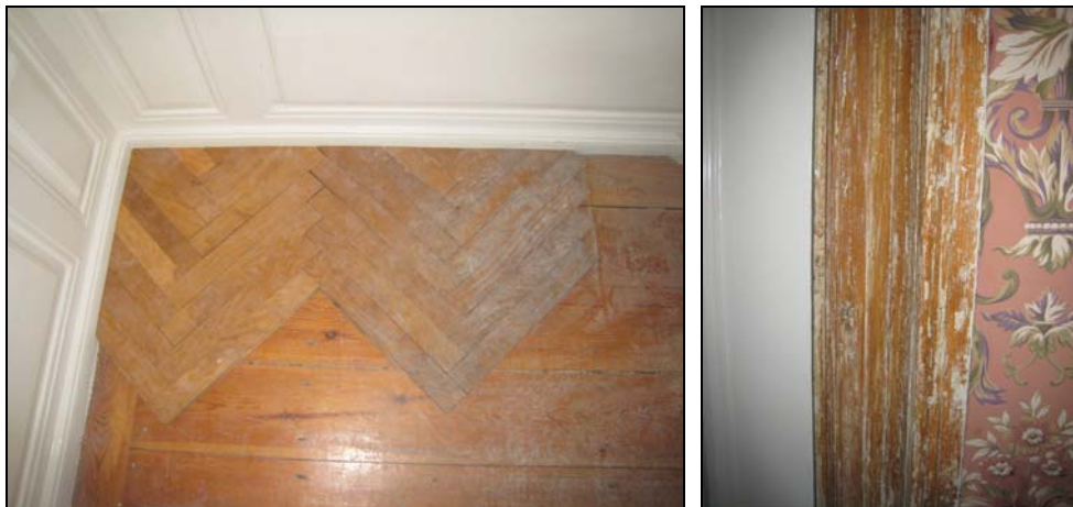
Figur 16. Upptaget parti med parkettstavar från salen vilkas ytskikt skadats i samband med vattenskadan. Foto: Helén Sjökvist.
