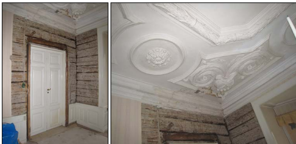
Figur 4. Befintlig vattenskadad puts och tapet togs ned från väggarna omkring dörrpartiet. Även dörrfodret är demonterat. Foto: Helén Sjökvist.
