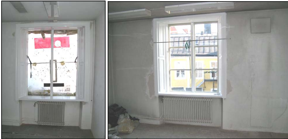
Figur 27. Nyupptaget fönster i arkivet med nya snickerier i nischen. Fönsterbågen ej återmonterad. Foto: Helén Sjökvist.
