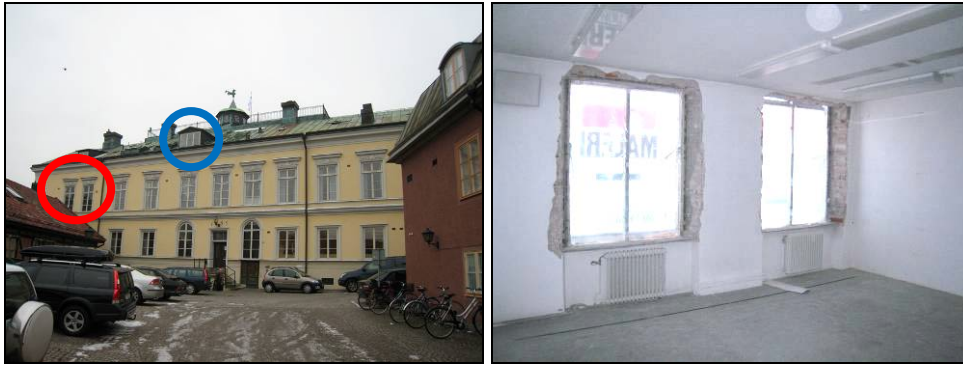
Figur 25. Blindfönster som tagits upp i arkivet markerade med en röd ring. Den blå ringen markerar det fönster som fått nytt karmbottenstycke och nytt bottenstycke på bågar. Foto: Helén Sjökvist.
