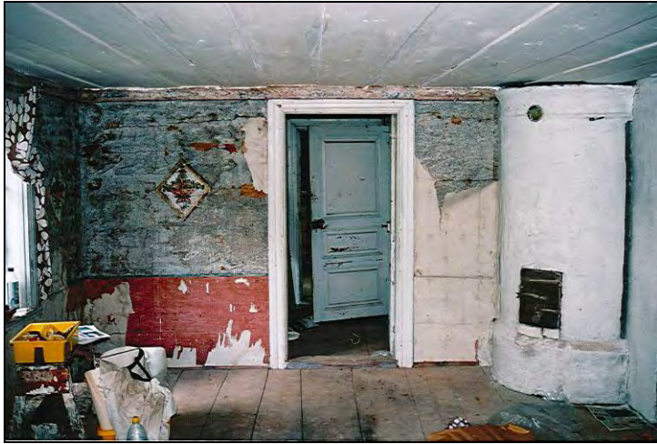
Figur 6. Västra väggen före konserveringsinsatser. Foto: Helén Sjökvist.
