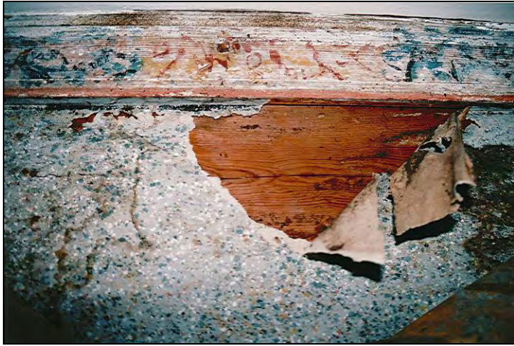
Figur 12. Bemålad taklist samt målningar där originalpappen släpper från timret. Foto: Helén Sjökvist.
