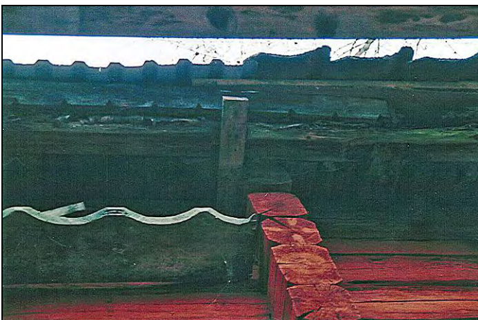
Figur 5. Direkt under taket anas vad som kan vara en rest av en äldre mullbräda med vattenavrinningspår. Foto: Helén Sjökvist.
