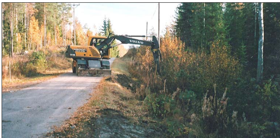
Figur 1. Den nya vattenledningens sträckning var placerad i vägbankens sluttning. Den gamla vattenledningen ligger i buskvegetationen nedanför vägbanken. Strax under asfaltkanten låg även en elledning som var okänd inför undersökningen. Foto från väst. (Foto U. Alström.)
