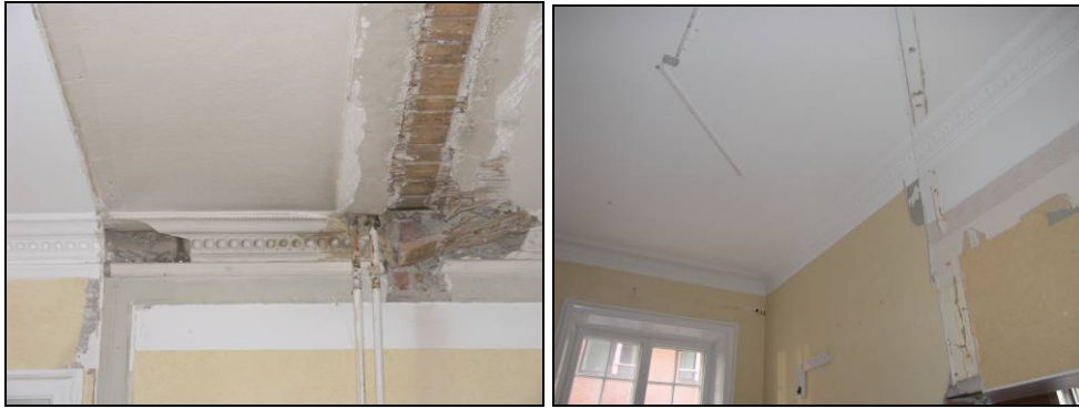
Figur 62. På flera ställen i lägenheterna blev stucklisterna synliga efter att senare tillkomna väggar och innertak demonterats. På bilden syns även takens konstruktion med puts på vassmatta.
