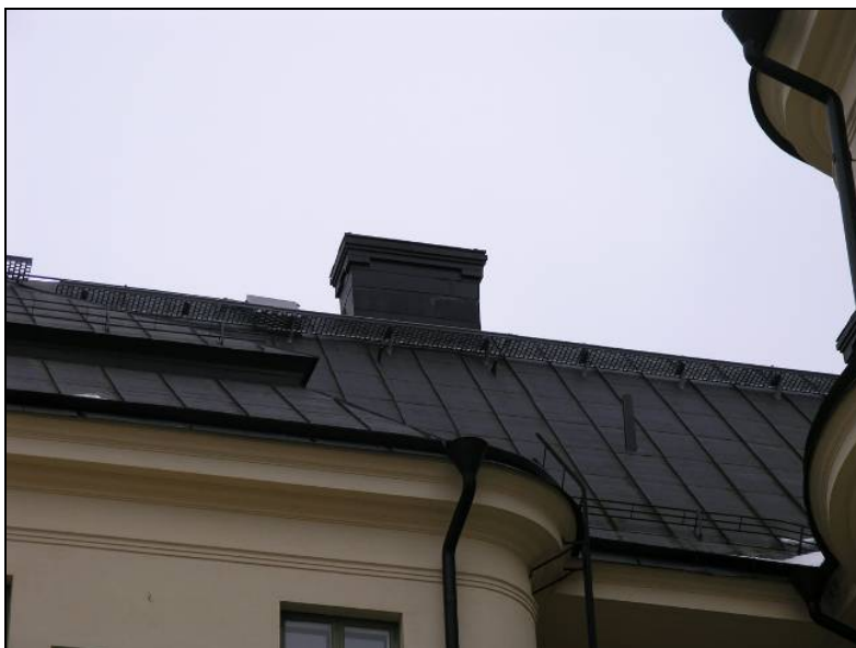
Figur 6. Baksidans takefall. Takplåtarna ligger med tvärfalsar som inte är förskjutna.
