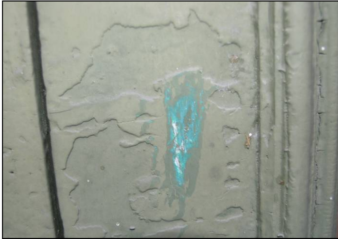
Figur 26 Spår av en tidigare mer kromoxidgrön färgton på en balkongdörr.
