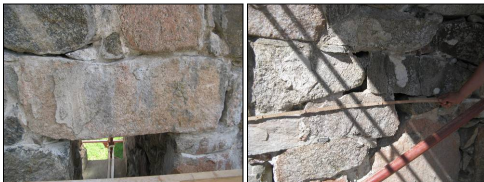
Figur 39. Putsfragment över öppningen i gavelröstet. Västra sidan. Foto: Helén Sjökvist.
