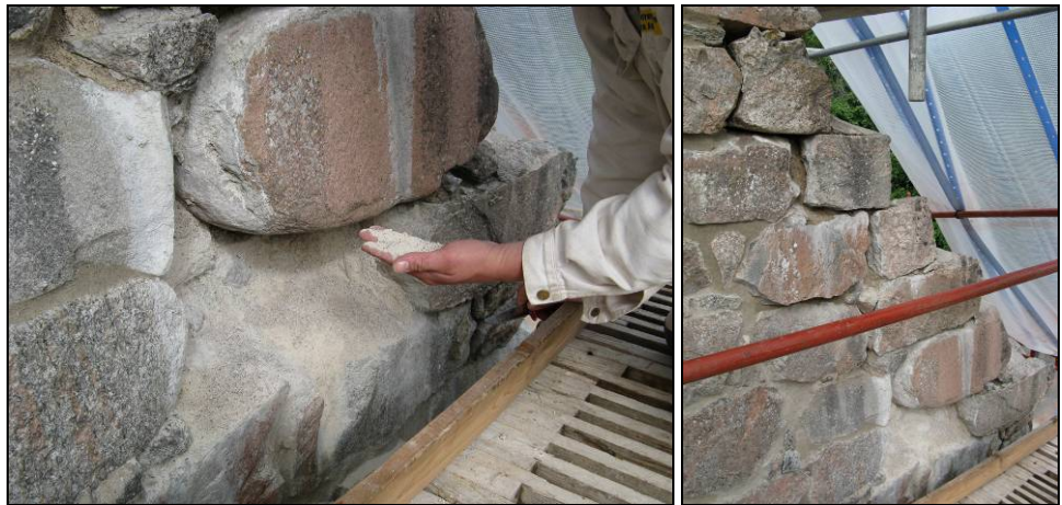
Figur 47. Gavelröstets östra sida, mot norr. Brukets bindemedel hade helt urlakats och endast sand återstod. Foto: Helén Sjökvist.
