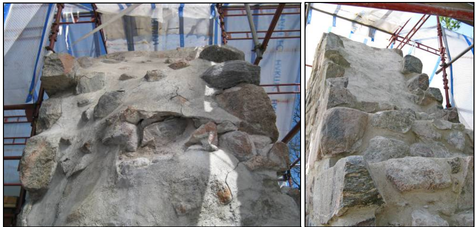
Figur 37. Gavelröstets gamla avtäckning på den södra lutningen. Omfattande bortfall av avtäckning har lett in vatten i murverket. Murbruket var mycket vittrat under avtäckningen och sanden rann ur muren vid arbetet med bortrensningen. Foto: Helén Sjökvist.
