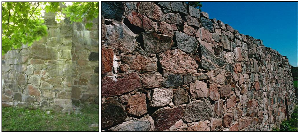
Figur 17. Långhusets yttre vägg, nordvästra hörnet före åtgärder. En sättningsskada gjorde att en omfattande spricka uppträdde. Väggens buktade även utåt men troligen har den rörelsen avstannat då inga sprickor fanns i det senare tillkomna fogbruket. Foto: Helén Sjökvist.
