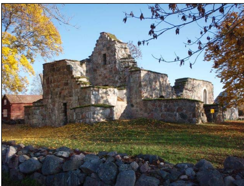
Figur 62. Ruinen sedd från sydväst efter renoveringsetappens slutförande. Foto: Cecilia Lagerfalk-Rooth, Länsstyrelsen i Västmanlands län.
