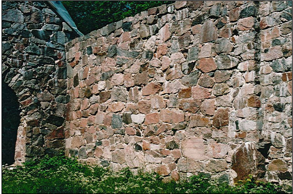
Figur 23. Övre partiet av norra långhusväggen hade skadats delvis på grund av sättningar och delvis på grund av att betongavtäckningen hade spruckit upp och vatten har kunnat urlaka murbruket. Foto: Helén Sjökvist.
