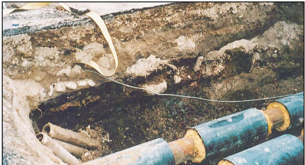
Figur 3. Kulturlager i den västra schaktväggen i det lilla serviceschaktet vid Torget. (Foto U. Alström.)
