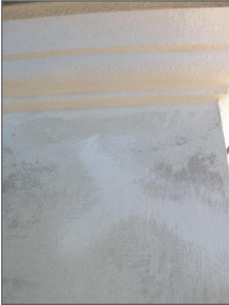
Figur 4. Putsskada ilagad med kalkbruk.
