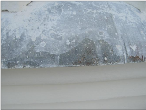
Figur 5. Plåt under tornluckor var angripen av rost.
