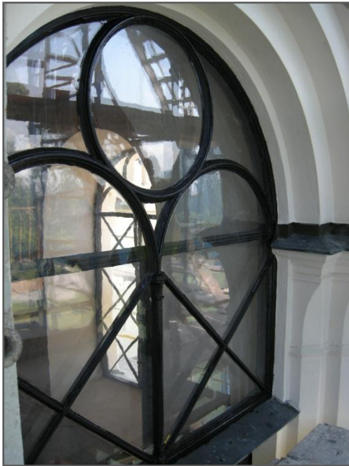
Figur 10. Krysset till böger i västsidans fönster visade sig vara av trä.
