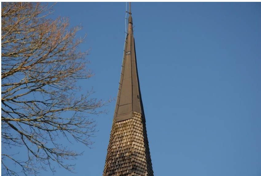
Figur 8. Tornspirans plåtbeklädnad före renovering. Foto: Lars Åke Augustsson.
