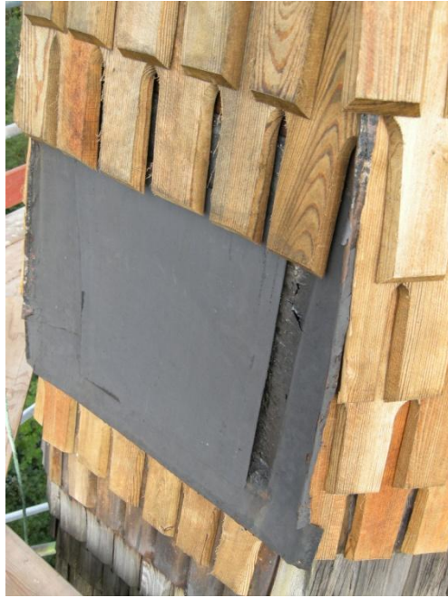
Figur 14. Lucka på tornspirans södersida var i mycket dåligt skick.
