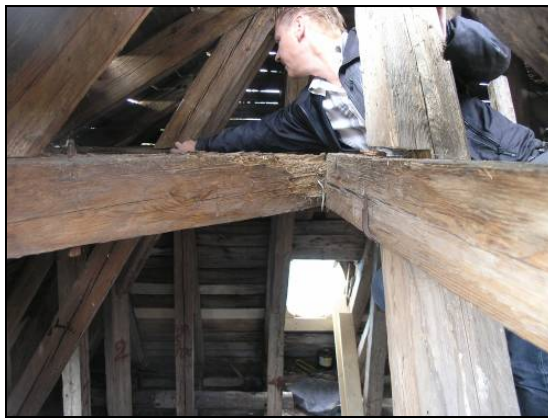
Figur 58. Oscar Mässing skadebesiktigar rötskador i lanterninens stomme. Foto: Helén Sjökvist.
