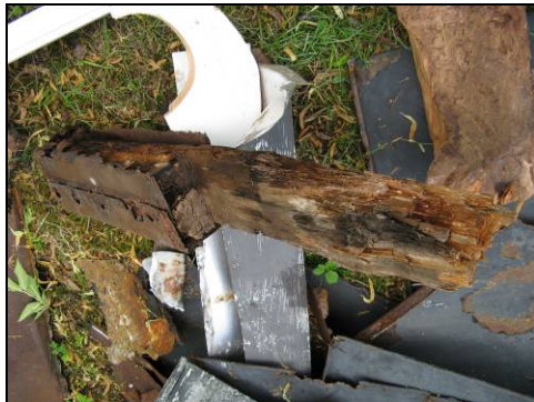
Figur 21. Rötskadad korsstock. Foto: Helén Sjökvist.
