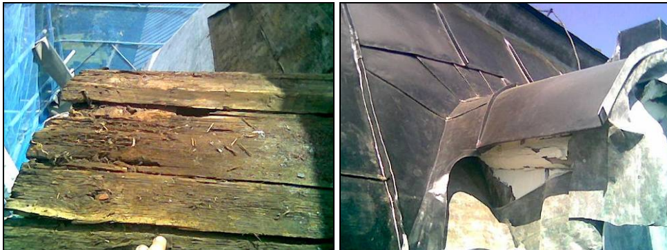
Figur 63. Virket i undertaket på takkuporna var mycket rötskadat. Foto: Aros plåt och vent.
