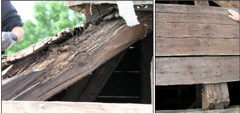
Figur 56. Rötskador i torntakets stomme. Foto: Helén Sjökvist.
