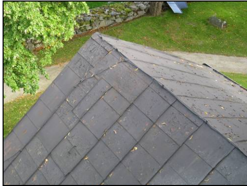
Figur 13. Sakristians tak före åtgärder. Foto: Helén Sjökvist.
