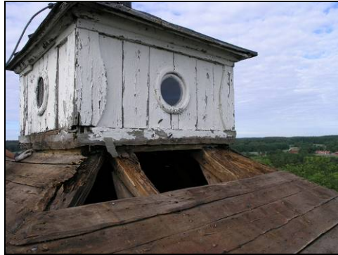
Figur 51. Omfattande rötskador i lanterninens stomme. Foto: Helén Sjökvist.
