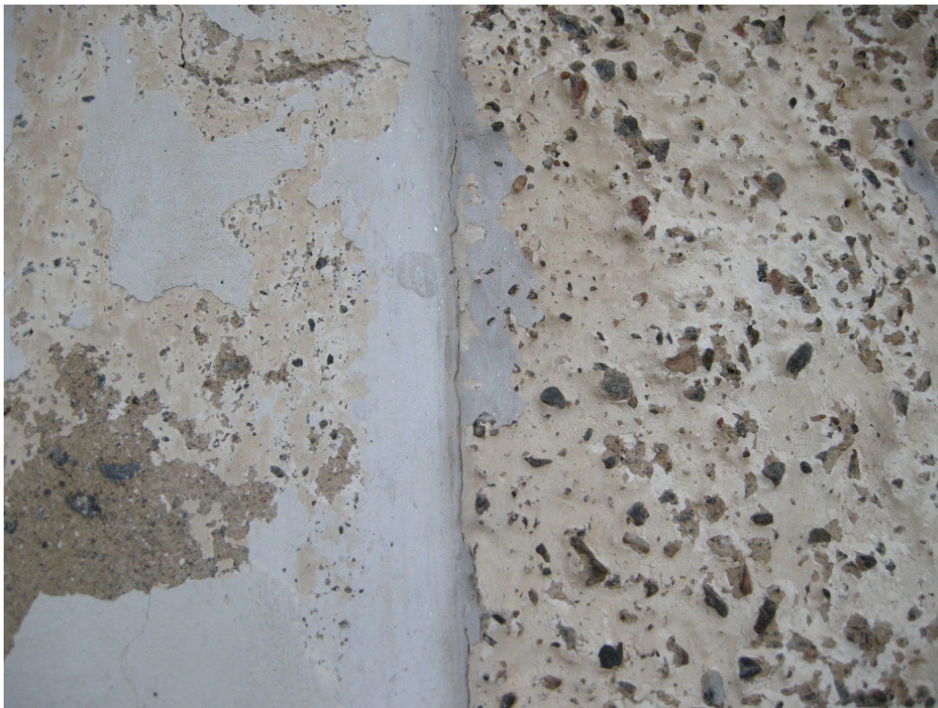
Bild 32. Efter tvättning framkom att de slätputsade partierna på kyrkobyggnadens fasad tidigare varit avfärgade i samma kulör som spritputsen. Foto: Boel Melin.
