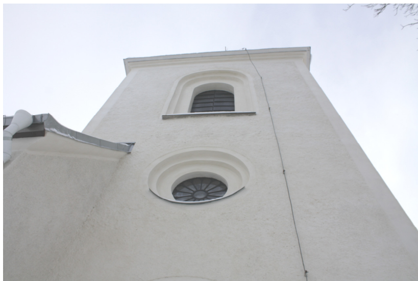
Bild 19. Tornets norra fasad efter avfärgning. Bilden visar även den riktade åskledaren. Foto: Boel Melin.
