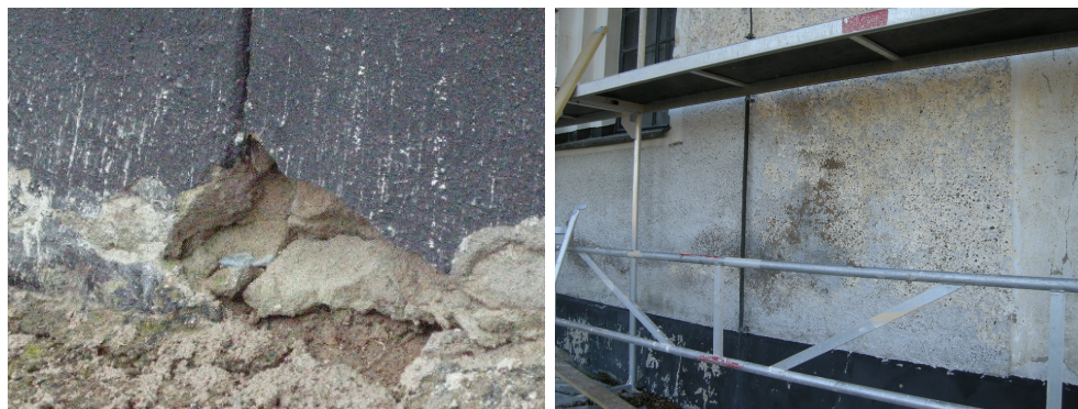
T.v. Bild 7. Del av frostsprängd sockel på östra gaveln, innan åtgärd. Foto: Boel Melin.
