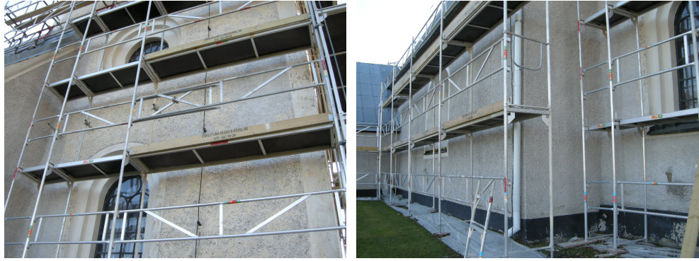
T.v. Bild 15. Tornets norra fasad, efter tvättning, innan avfärgning. Foto: Boel Melin.
