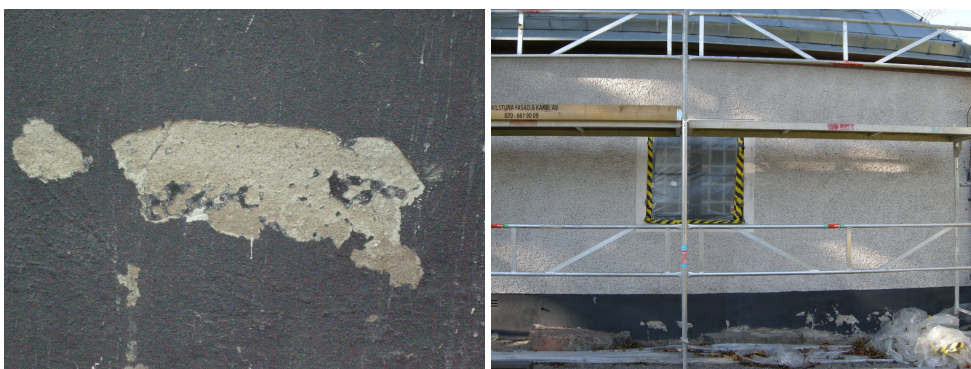
T.v. Bild 11. Ytputsbortfall på långhusets norra sockel. Foto: Boel Melin.
