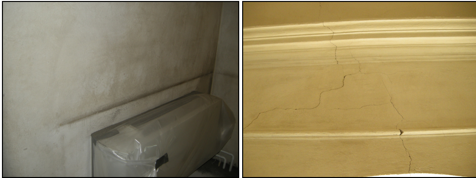
T.v. Bild 12. Nedsmutsat väggparti innan åtgärd. Foto: Boel Melin.
