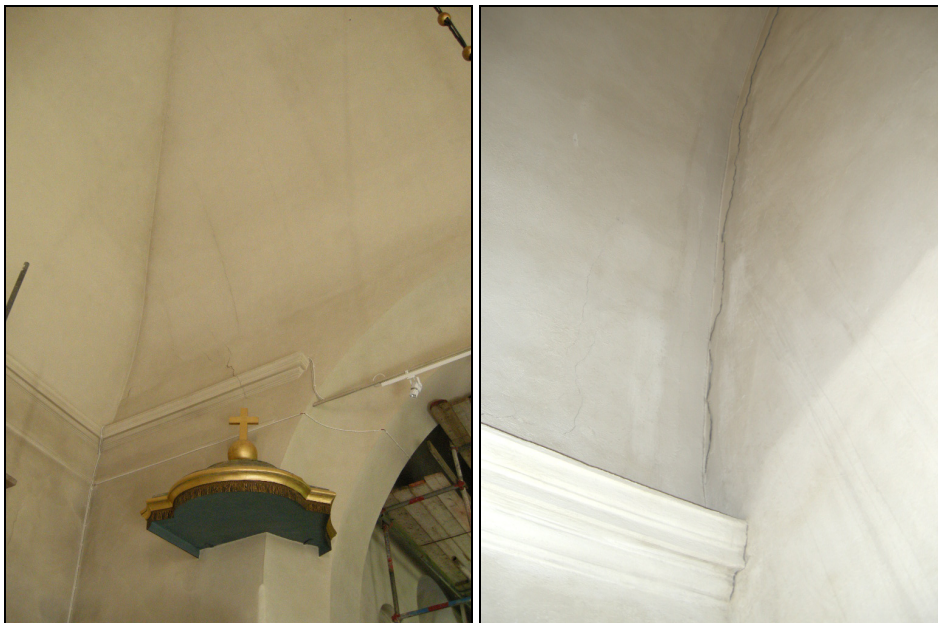
T.v. Bild 16. Väggparti mot kor innan åtgärd. Foto: Anna Gütblein.
