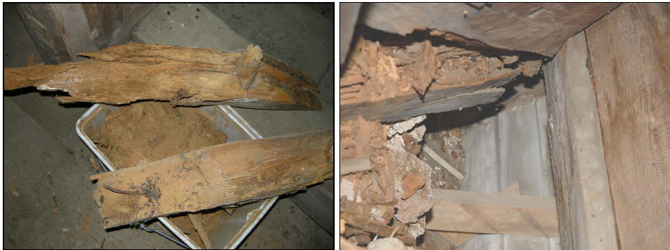
T.v. Bild 9. Rötskadat virke från tornets träkonstruktion. Foto: Boel Melin.
