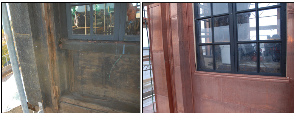
T.v. Bild 60. Södra lanterninfönstret och fasad innan åtgärd. Foto: Anna Gütthlein.
