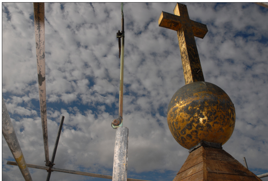
Bild 76. Kors och kula innan nedtagning. Det var svårt att ana omfattningen av skadorna innan plättäckningen togs bort i verkstaden. Foto: Lars-Åke Augustsson.
