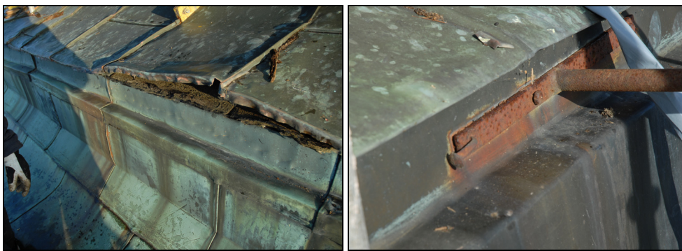
T.v. och t.h. Bild 13 och 14. De befintliga plåtarbetena var inte fackmannamässigt utförda. Foto: Lars-Åke Augustsson.
