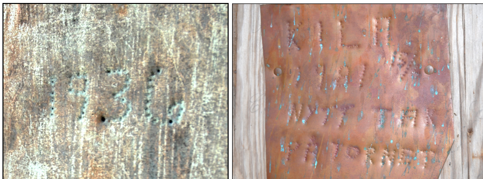
T.v. Bild 2. Inskriptionen visar att delar av befintlig lanterninplåt lades år 1936. Foto: Lars-Åke Augustsson.
