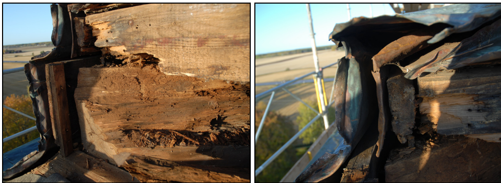
T.v. Bild 11. Yttre rötskadad panel på tornlanternin efter plåtavtäckning. Foto: Lars-Åke Augustsson.
