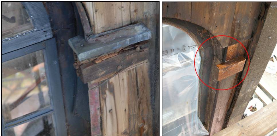
T.v. Bild 52. Rötskadad del av fönsteromfattning. Foto: Boel Melin.
