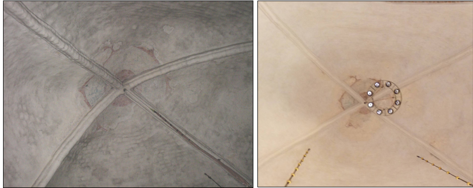
T.v. Bild 18. Valvhjässans cirkelornament innan rengöring. Bilden visar även valvets ribbor och kappor innan rengöring och laving. Foto: Thomas Wängelin.
