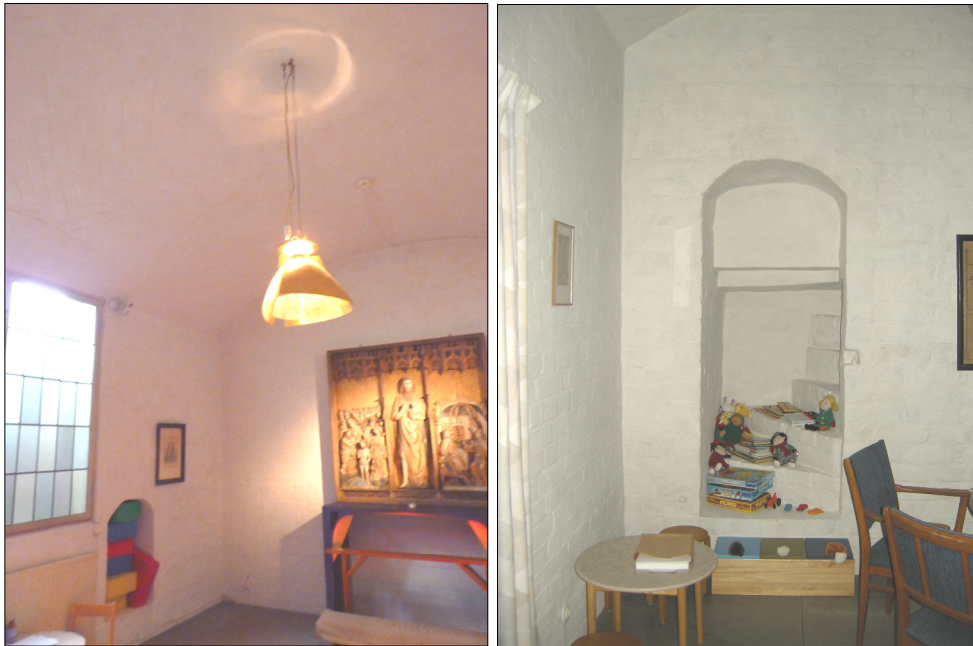
T.v. Bild 44. Tunnvalv och väggar i travé P efter rengöring och lavering. Foto: Boel Melin.
