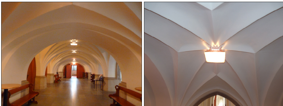
T.v. Bild 46. Stjärnvalv under läktaren efter rengöring och lavering. Foto: Boel Melin.
