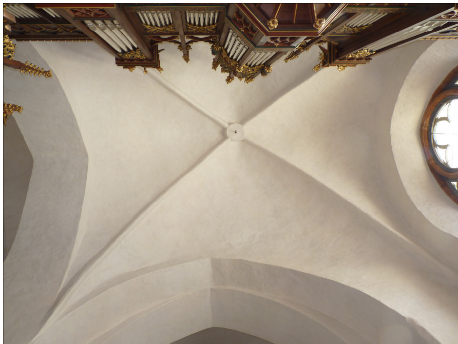
Bild 43. Kryssvalv i travé O efter rengöring och lavering. Foto: Boel Melin.
