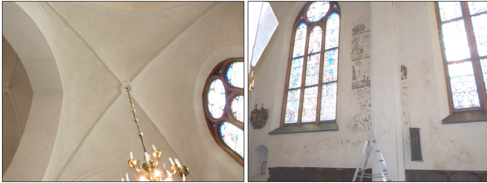
T.v. Bild 21. Travé E:s kryssvalv efter rengöring och lavering. Foto: Boel Melin.
