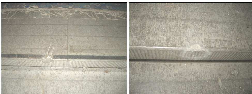
T.v. Bild 55. Slagskada på trappsteg upp mot koret. Foto: Boel Melin.
