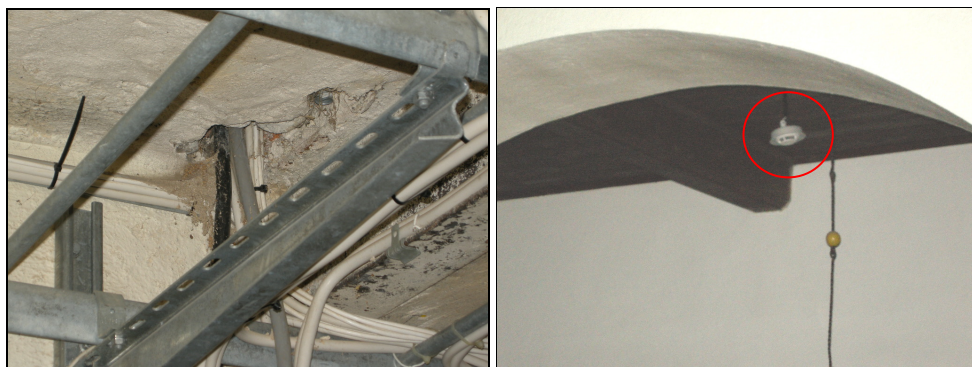
T.v. Bild 6. Äldre befintliga installationer i källaren. Dragning av sladdar följde de redan befintliga dragningar. Foto: Boel Melin.
