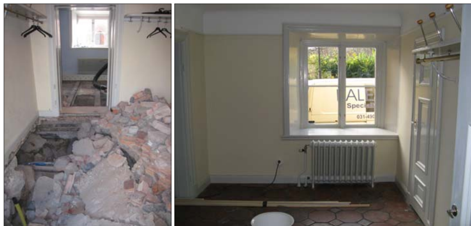
Figur 103. Under betongjutningen i rum 133 fanns stora mängder byggsrot som utfyllnad. Stora mängder material fick fraktas bort för att komma åt de djupt liggande rören. Foto: Helén Sjökvist.
