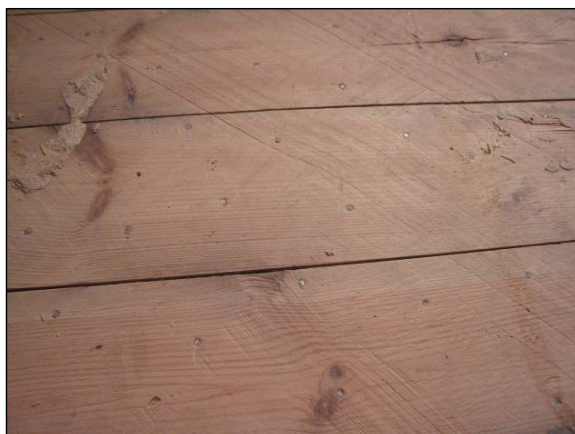
Figur 46. Tätt spikat i trägolv. Foto: Helén Sjökvist.
