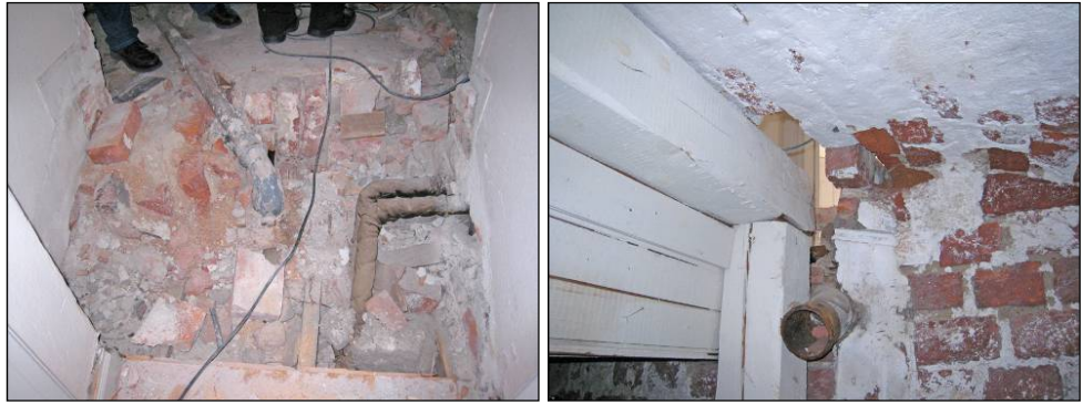
Figur 50. Befintliga rör som går ned i källaren under rum 116. Foto: Helén Sjökvist.
