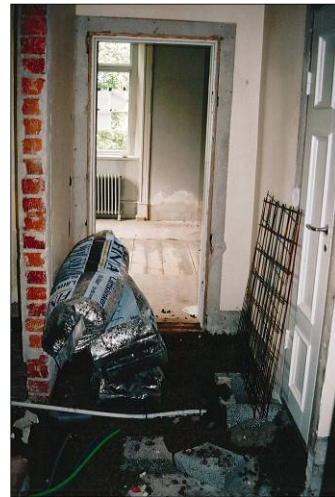
Figur 59. Golvet fylldes ut med lecakulor för att få en jämn yta och för att skydda underliggande lager före läggning av nytt golv. Foto: Helén Sjökvist.
