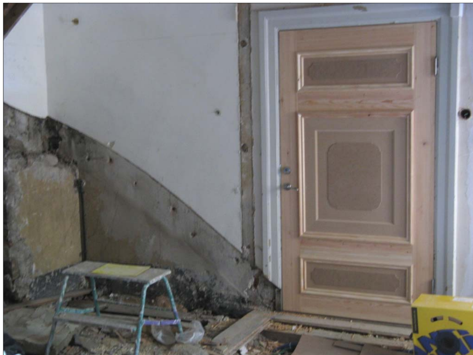
Figur 95. Dörröppningen kompletterades med ytterligare ett dörrblad för att den nya beslagningen och larmet inte skulle påverka det äldre dörrbladet. Foto: Helen Sjökvist.
