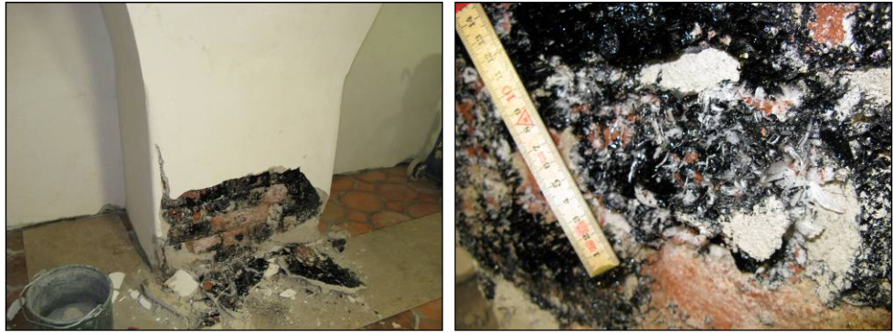
Figur 40. Den stora mängden saltkristaller på pelaren gjorde att putsen sprängdes loss från underlaget. Foto: Helén Sjökvist.
