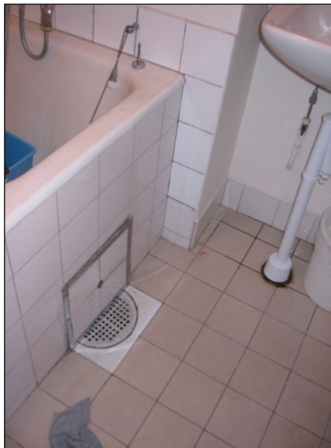
Figur 111. Golv och badkar före åtgärder. Foto: Helen Sjökvist.
