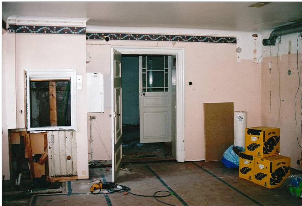
Figur 78. Vid upptagningen av ett hål för eldragningar under hissen upptäcktes pärlspontpanel under nuvarande skivmaterial. Foto: Helén Sjökvist.
