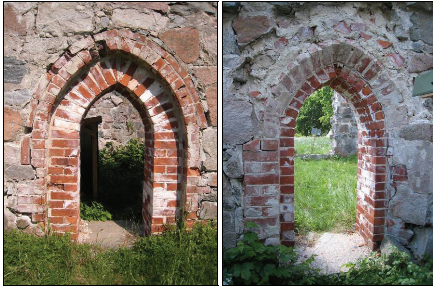
Figur 35. Sakristieportalen före åtgärder sedd från långhuset. Teglet är mycket frostsprängt. Foto: Helén Sjökvist.
