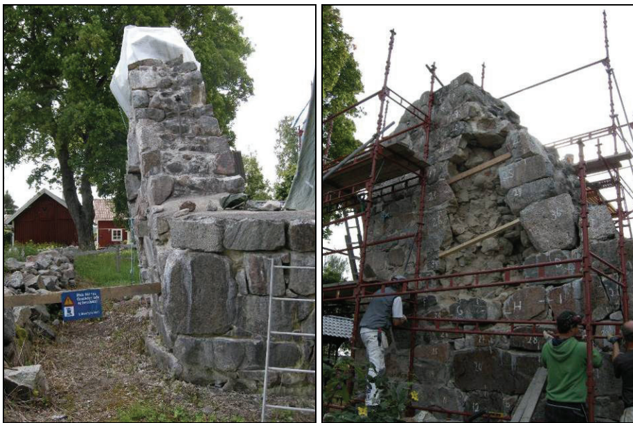
Figur 49. Kormuren kalvade kraftigt utåt innan åtgärd. Foto: Anna Gütblein.
