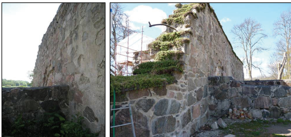
Figur 23. Norra muren sedd från nordväst före renovering. Foto: Helén Sjökvist.
