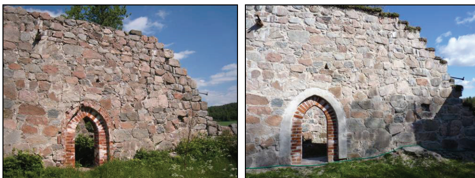
Figur 21. Norra murens östra parti sedd från långhuset före restaureringen. Som synes kvarstod ytterst lite av fogbruket och stenarna låg löst. Foto: Helén Sjökvist.
