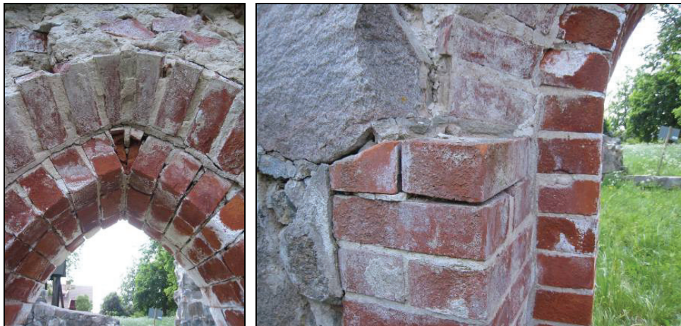
Figur 37. Sakristieportalen sedd från sakristian. Slutstenen frostsprängd. Foto: Helén Sjökvist.
