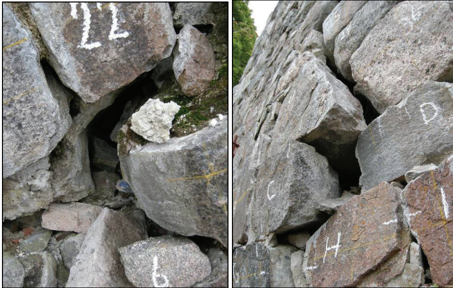
Figur 47. Mellan stenarna har man vid tidigare restaureringsinsatser injicerat betong, vilken låg som klumpar. Foto: Anna Gütblein.
