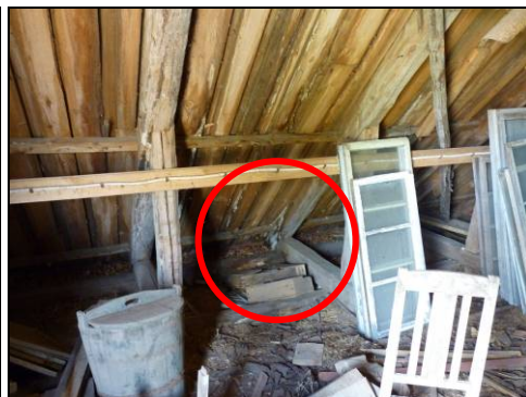
Figur 9. Exempel på rötskador i undertak och takstol. Foto: Helén Sjökvist.
