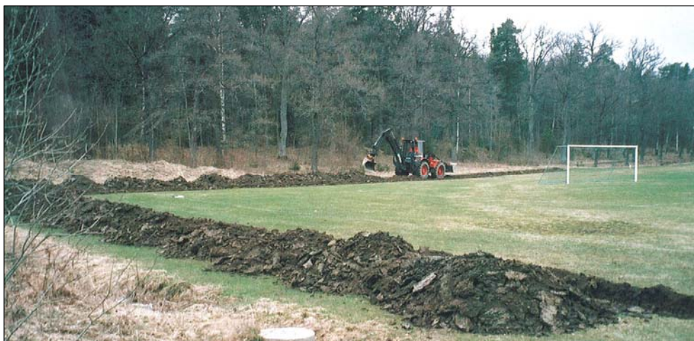
Figur 1. Grävning av det cirka 100 m långa schaktet vid Rocklundas fotbollsplaner. (Foto från sydöst U. Alström.)
