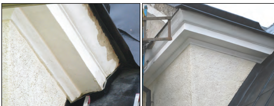
T.v. Bild 21. Putslagning på långhusets taklist vid anslutning till sakristia innan avfärgning. Foto: Boel Melin.
