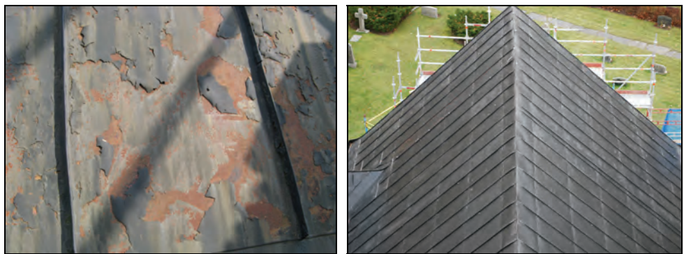
T.v. Bild 10. Färgbortfall och korrosion på långhusets takplåt. Foto: Boel Melin.
