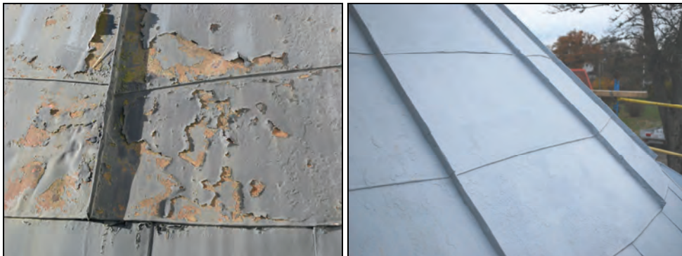
T.v. Bild 15. Flagnande färg och korrosion på kortakets plåttäckning. Foto: Boel Melin.
