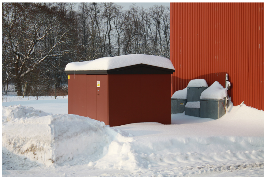
Bild 4. Transformatorstation efter arbetena. Foto: Boel Melin.
