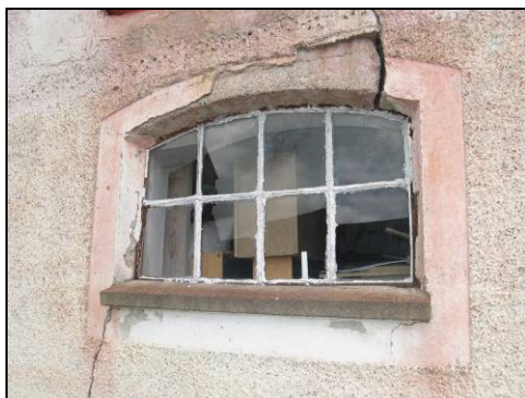
Figur 16. Fönsterbågar av gjutjärn i behov av omkittning. Omfattande sättningsprickor vid fönsteröppning. Foto: Helén Sjökvist.
