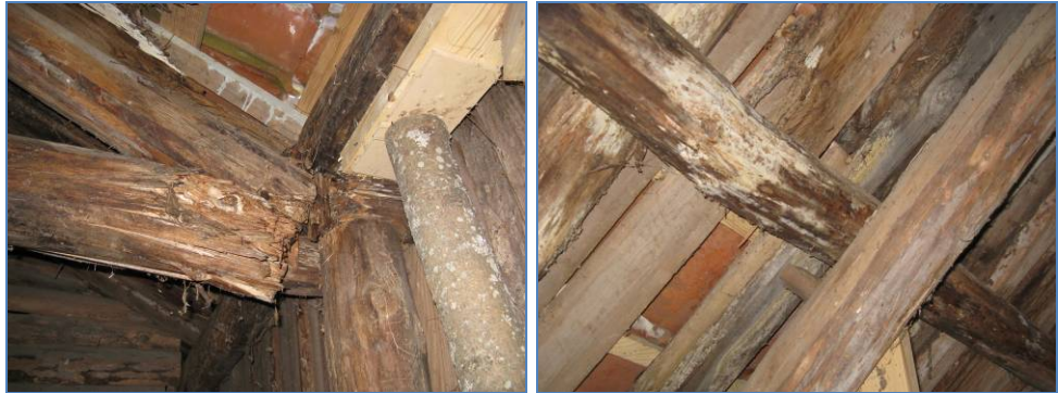
Figur 8. Lada/ladugård. Hammarbandet är av på östra sidan, ungefär mitt på byggnaden. Foto: Helén Sjökvist.
