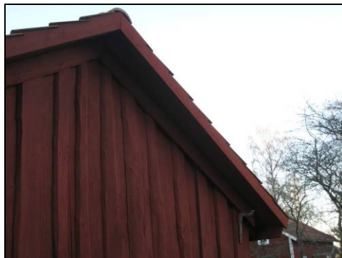
Figur 28. Nya vindskivor utfördes med urtag för tegel precis som man tidigare haft på byggnaden. Foto: Helén Sjökvist.
