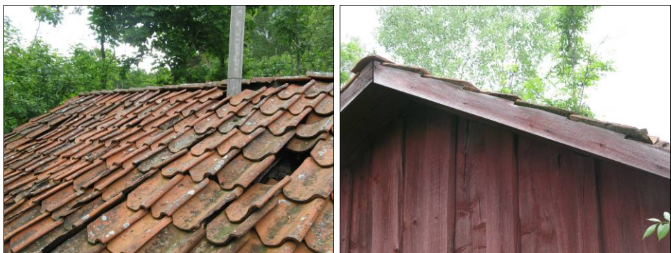
Figur 10. Jordkällare. Taket täcks med tegel från Köpings kyrkas tegelbruk. Teglet är frostsprängt. Foto: Helén Sjökvist.
