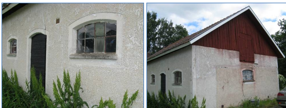
Figur 14. Hönsbuset med fasad målad med plastfärg samt sprickor över dörröppning. Foto: Helén Sjökvist.
