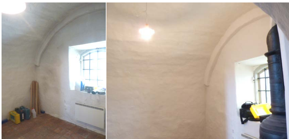
T.v. Bild 8. Sakristians tunnvalv och nordvästra hörn innan rengöring och avfärgning. Vegg- och valhytorna uppvisade fläckar och nedsmutsning samt allmänt färgbortfall. Foto: Boel Melin.
