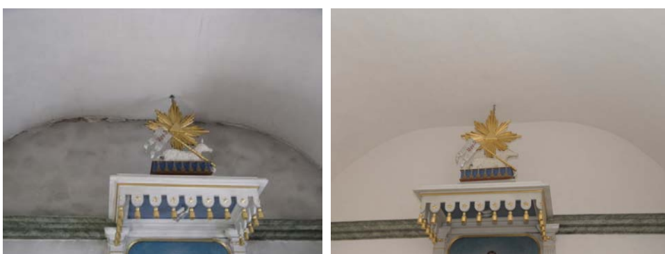
T.v. Bild 26. Östra kornäggen och tunnvalv innan åtgärder. Här förekom sprickor i anslutningen samt nedsmutsning. Foto: Boel Melin.
