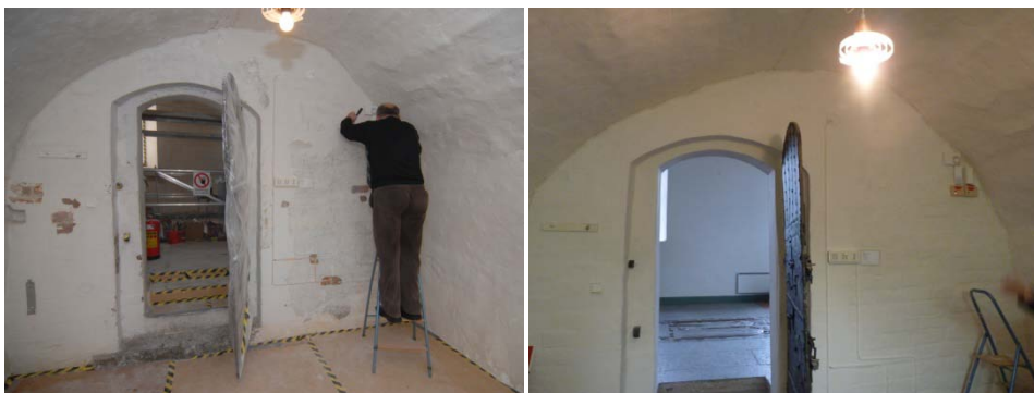
T.v. Bild 10. Sakristians södra vägg innan åtgärder. Bilden visar flera områden av färgbortfall. Foto: Per Lindahl.
