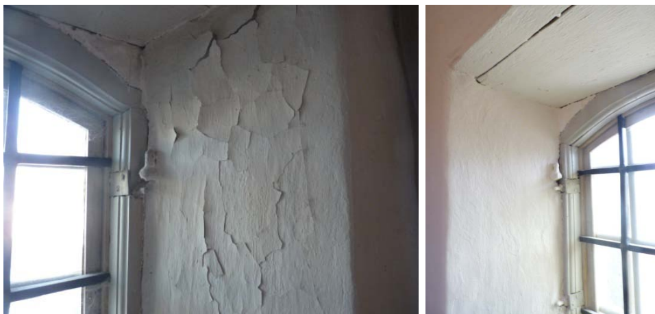
T.v. Bild 12. Fönstersmyg i sakristia uppvisade puts- och färgsläpp. Foto: Boel Melin.
