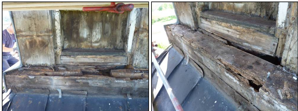
Figur 26. Plåten bortplockad från lanterninens norra sida. Omfattande rötskador i virket under fönstret. Foto: Helén Sjökvist.
