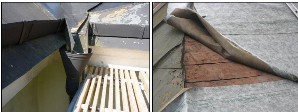
Figur 43. Takavvattning mellan Mariakoret och långhuset före åtgärder. Foto: Helén Sjökvist.
