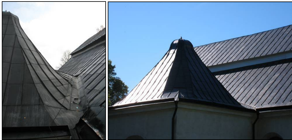
Figur 47. Under vinkelrännan mellan långhuset och Mariakapellet ligger en plyfa för att stadga upp plåten. Foto: Helén Sjökvist.
