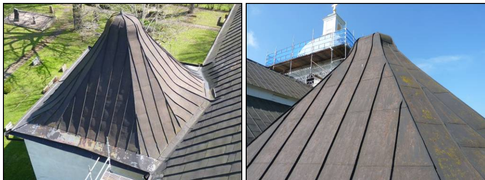
Figur 16. Plåttaket på Mariakoret har en annan falsindelning, anpassad efter takfallens utformning. Foto: Helén Sjökvist.
