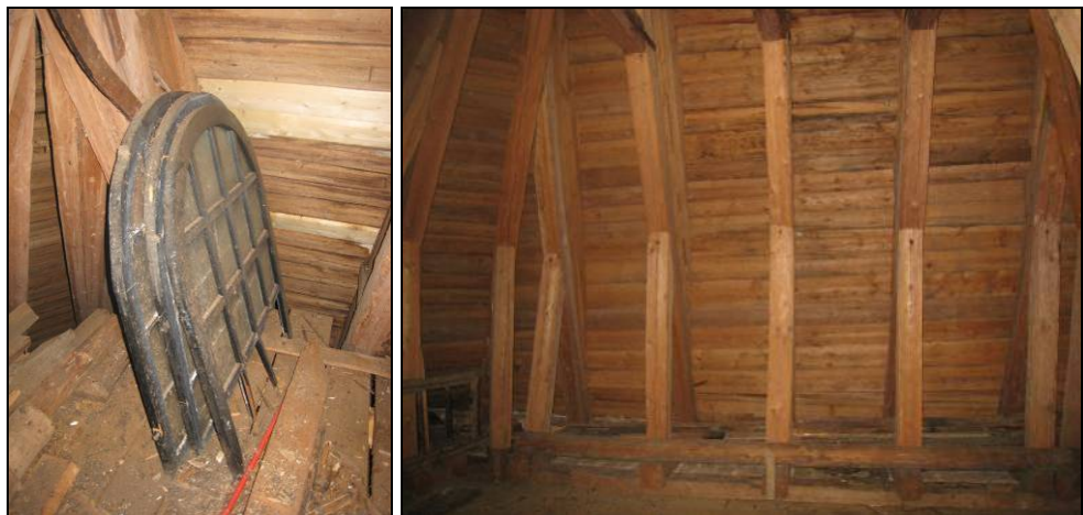
Figur 35. Gamla fönsterbågar till lanterninen vilka förvaras på tornvinden. Några enstaka bräder i det bakomvarande undertaket är utbytta i samband med takarbetet. Foto: Helén Sjökvist.
