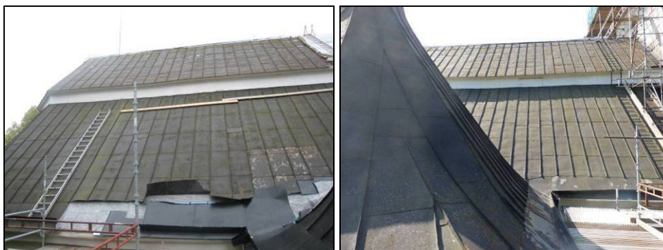
Figur 49. Påbörjad rivning av plåten på norra långhustaket. I bildens nedre högra del anas igensättningen efter den gamla skorstenen. Foto: Helén Sjökvist.
