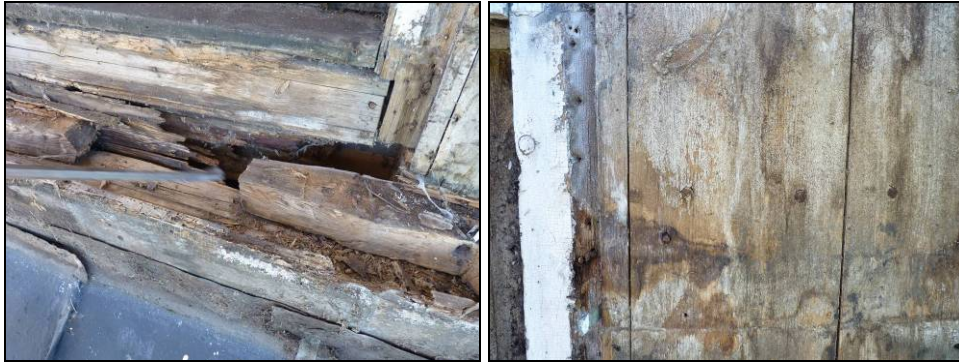
Figur 28. Plåten bortplockad från lanterninens norra sida. Omfattande rötskador i virket under fönstret. Foto: Helén Sjökvist.
