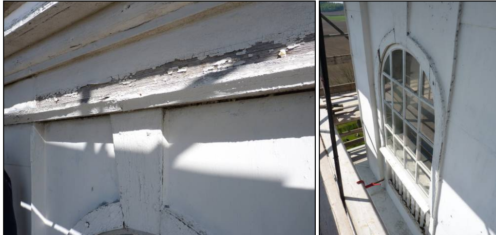
Figur 22. Lanterninens väggfält och hörnkedjor är plåtklädda sedan tidigare. Bräda över kilformat parti plåtkläddes 2010 men takfot, fönsteromfattning och konformad dekoration behålls i trä. Foto: Helén Sjökvist.
