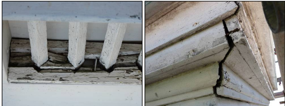
Figur 24. Spjälverk under det östra fönstret är mycket rötskadat. Foto: Helén Sjökvist.
