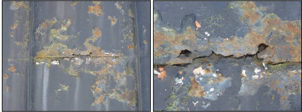
Figur 10. Tornbuvens norra sida med omfattande rostangrepp. Foto: Helén Sjökvist.
