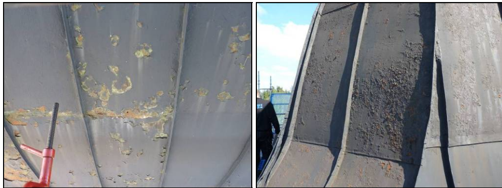
Figur 12. Rostangrepp på tornbuvens norra sida. Foto: Helén Sjökvist.
