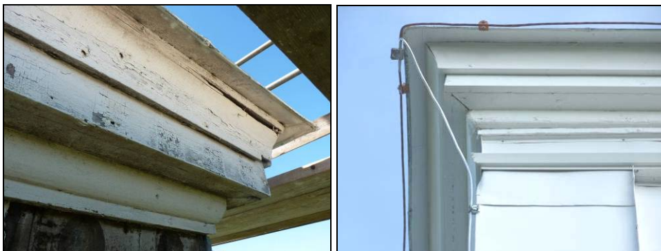
Figur 31. Takfotens övre lite konkava bräda var skadad och byttes. Foto: Helén Sjökvist.
