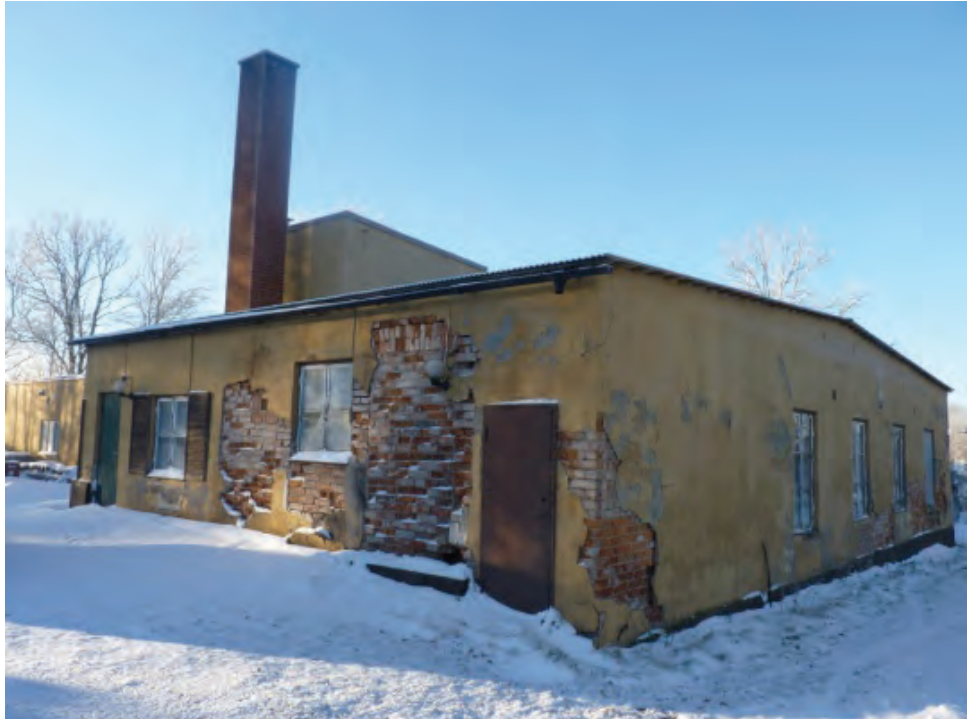
Figur 88. Verkstad vid Kungsstenen med omfattande putsbortfall.
