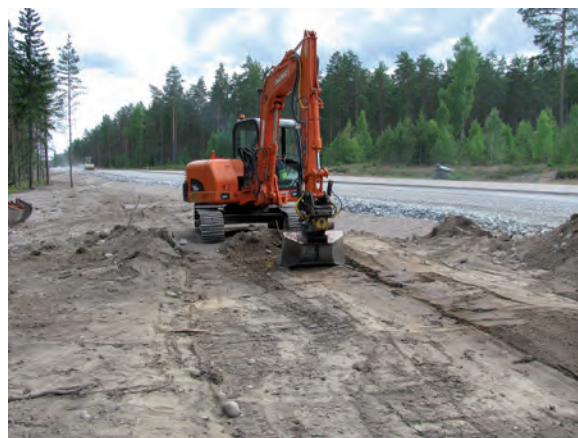
Fig. 5. Med hjälp av en liten grävare utfördes stora delar av återställningsarbetena. Här nyskapande av det sydligaste partiet av vägen Västerfärnebo 613. Foto R. Jensen 2010.
