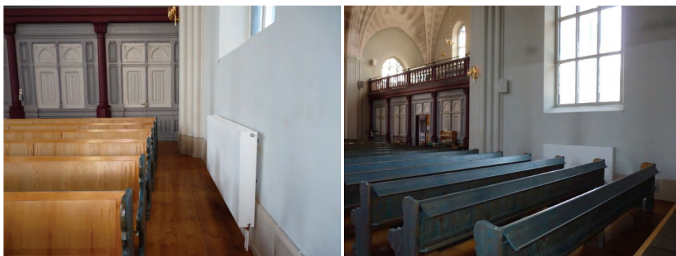
Figur 33. Ny radiator på norra väggen. Foto: Helén Sjökvist.
