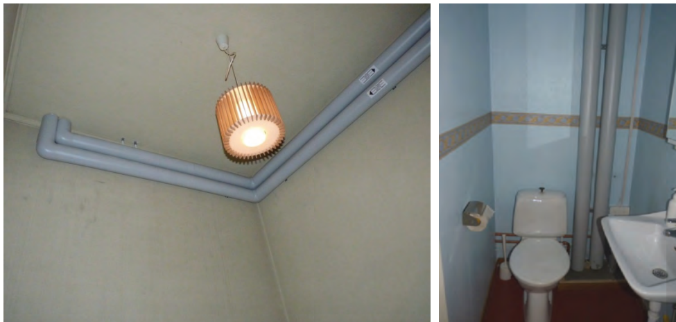
Figur 45. Rördragning i tak i utrymmet utanför pentryt bör byggas in på sikt. Foto: Helén Sjökvist.
