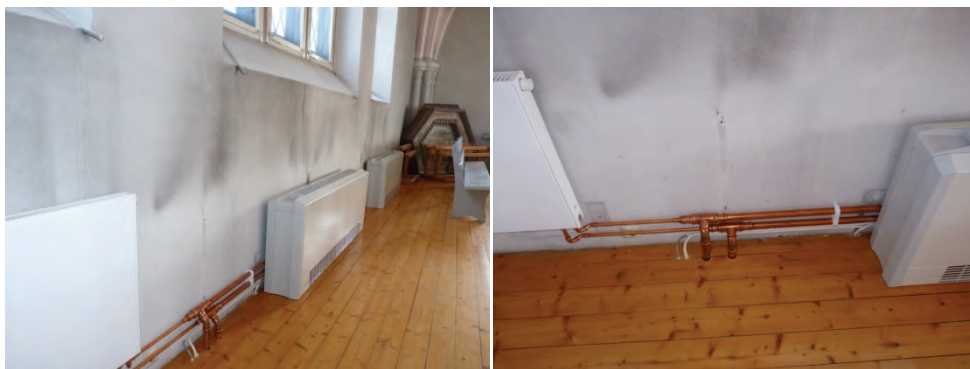
Figur 37. Norra läktaren med nya radiatorer och flätkonvektorer. Kopparrören skall målas in i bakgrundskulör. Foto: Helén Sjökvist.
