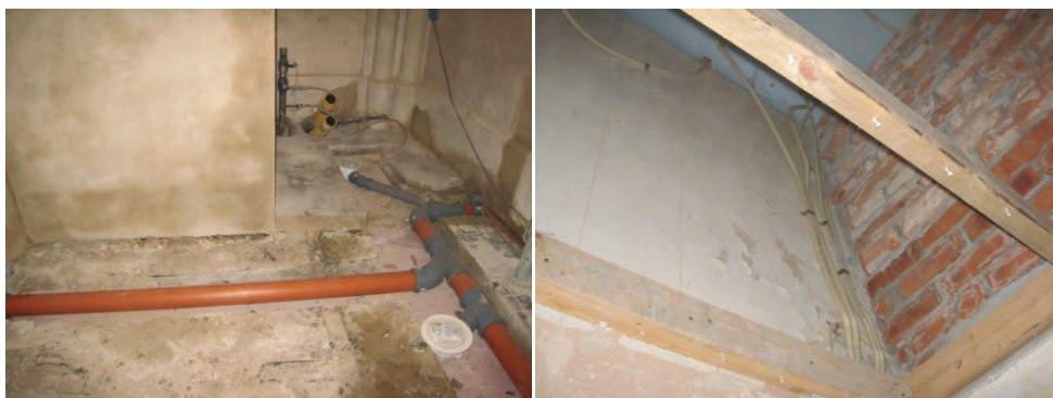
Figur 17. Kanaler för rördragningar och avloppsrör inne i värmecentralen mot väster. Foto: Helén Sjökvist.
