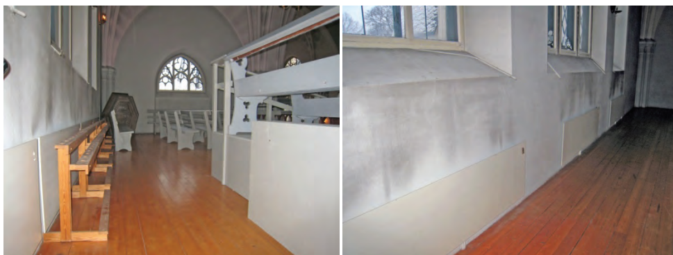
Figur 35. Norra läktaren med äldre radiatorer för direktverkande el. Foto: Helén Sjökvist.
