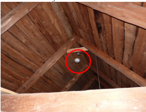
Figur 27. Detektor på vinden över långhuset. Foto: Helén Sjökvist.
