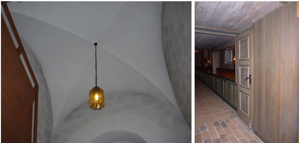
Figur 14. Vapenhusets valv före åtgärder. Foto: Helén Sjökvist.
