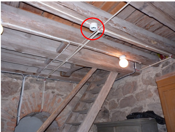
Figur 24. Monterad branddetektor o tornet. Foto: Helén Sjökvist.
