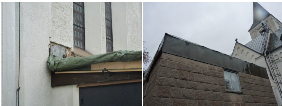
Figur 7. Ståndblecket mot kyrkans fasad har rivits loss och orsakat skador i putsen. Foto: Helén Sjökvist.
