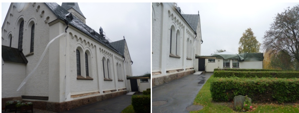
Figur 5. Saknade stuprör på kyrkans södra sida. Foto: Helén Sjökvist.
