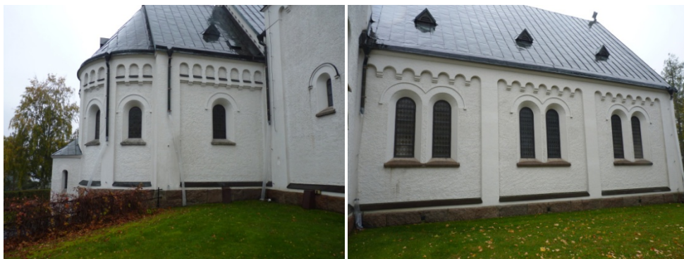
Figur 3. Saknade stuprör på korets norra sida. Foto: Helén Sjökvist.
