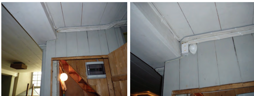
Figur 22. Sedan tidigare fanns en mängd kablar dragna mot panelen under läktartrappan. Foto: Boel Melin.
