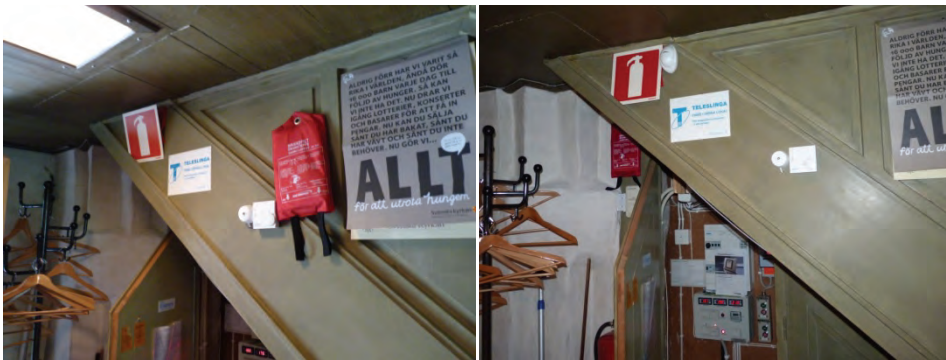
Figur 12. Läktartrappa före åtgärder. Foto: Boel Melin.
