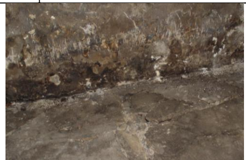
KM12114 Oljeön 20121008_43. Intill södra väggen i oljekällaren hade golvet spruckit och där togs prov J12-9.
