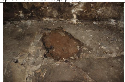
KM12114 Oljeön 20121008_45. Bitar av golvet vid J12-9 har lyfts bort och materialet under grunden framkom.
