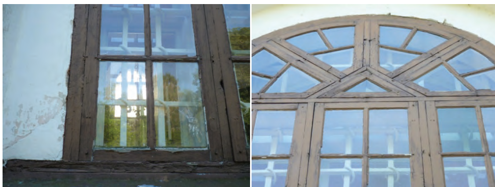
Figur 14. Norra fasadens sakristiefönster, med äldre rötskador i karmbottenstycket. Foto: Helén Sjökvist.
