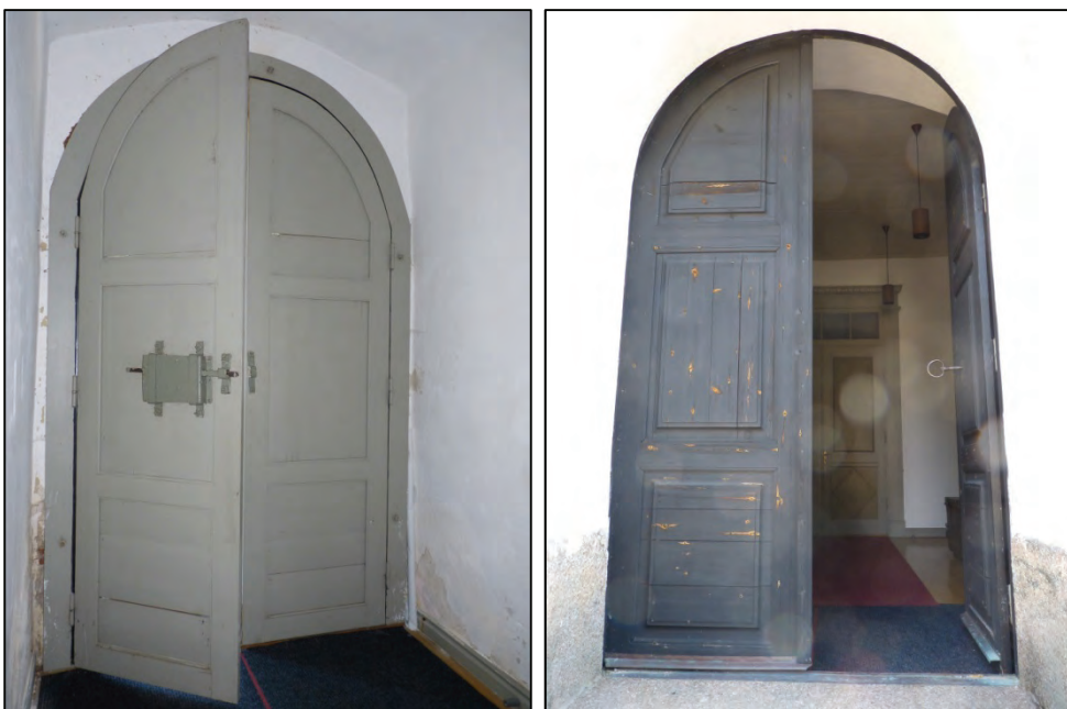
Figur 18. Västporten nyttillverkades i samband med renoveringen 1975–76, men det gamla låset tycks ha återanvänts. Foto: Helén Sjökvist.
