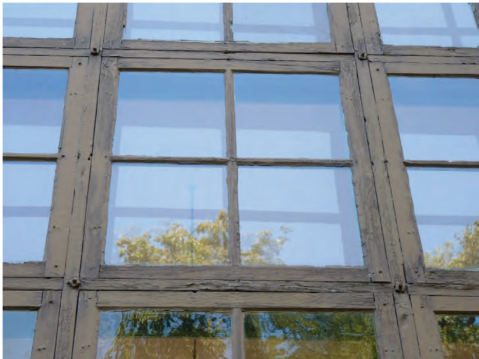
Figur 7. Norra fasadens fönster med fönstren monterade med fyrkantiga bultar. Foto: Helén Sjökvist.
