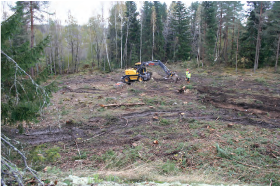
Figur 50. Kjula 298, när schakt 6462 påbörjas. Fotot taget från sydväst, uppifrån berget som i väster avgränsar boplatsen. Foto, Jenny Holm.
