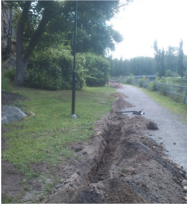
Figur 6. Fotograf som visar schaktet där det framkom kulturlager med inslag av hammarslagg. Till vänster ses en större sten. Vänster därom ses berget. Fotograferat från norr av Jonas Ros.
