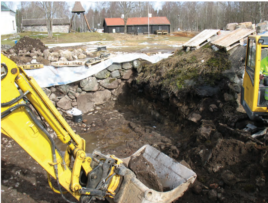
Figur 18 och 19. Arbetsbilder som visar hur schaktningen gick till inne i Dubbelkällaren. En mindre maskin schaktade invändigt och en större maskin hyfte ut massorna. Fotografi av Jonas Ros.
