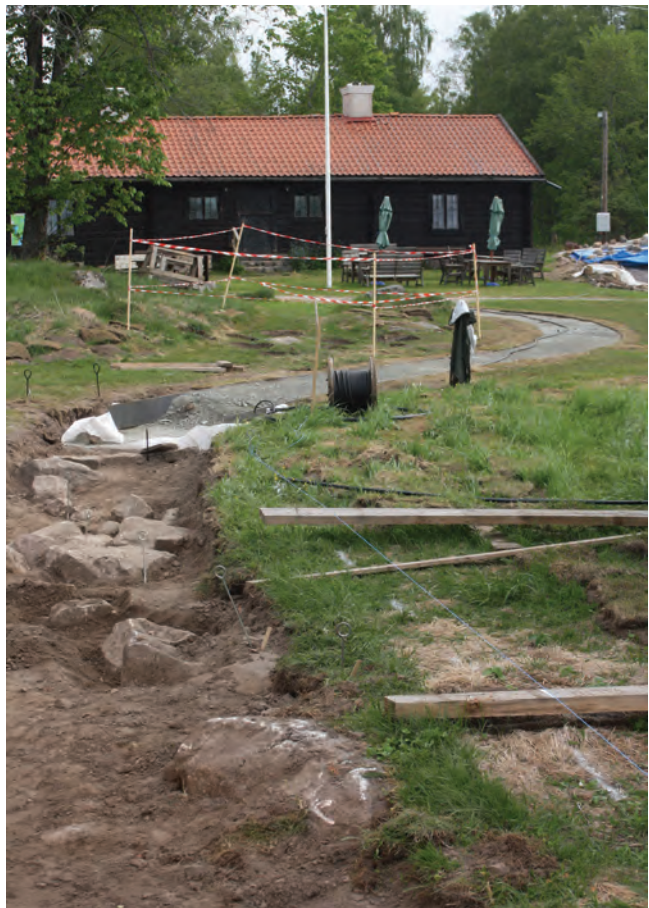
Figur 82. I förgrunden ett markfast block, därbakom Hus IIIa med syllstensraderna A9 och A7. Till höger syllstensrad A15 tillhörande Hus IIIb. I bakgrunden ses Sockenstugan. Fotograferat från söder av Jonas Ros.
