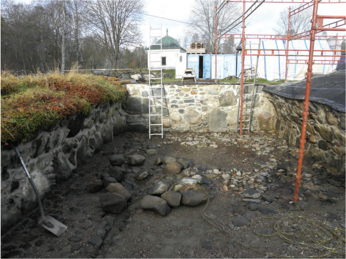
Figur 49. Dubbelkällarens västra rum sett från söder. Murarna har ommurats. I bakgrunden ses det Rosenholmska gravkapellet. Fotograferat från söder av Jonas Ros.
