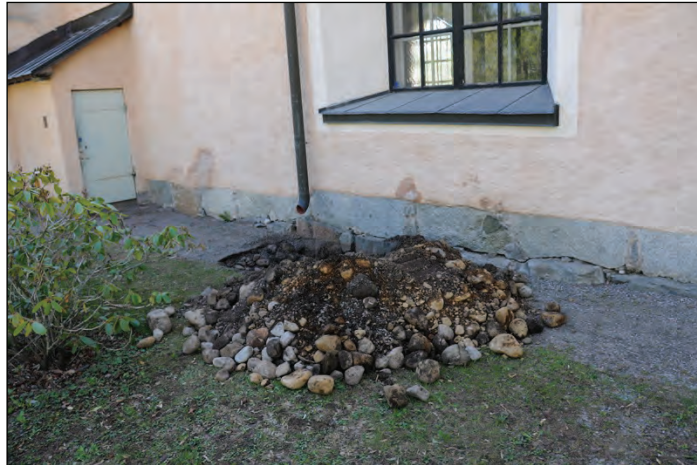
Figur 7. Schaktet intill kyrkans norra vägg där massorna mest bestod av sten i varierande storlek. (Foto från nordväst R. Hammarskiöld, Svensk Klimatstyrning.)
