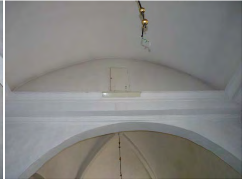
Figur 38. Lucka till kyrkvinden sedd från västligaste valvet före åtgärder.
