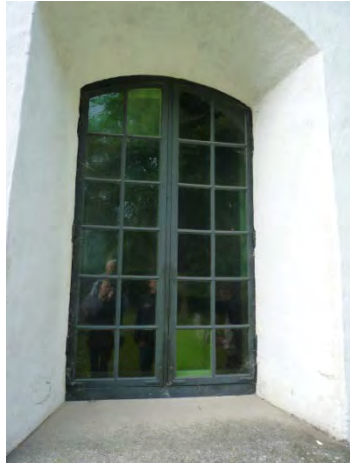
Figur 62. Fönster på norrsidan före ommålningen
