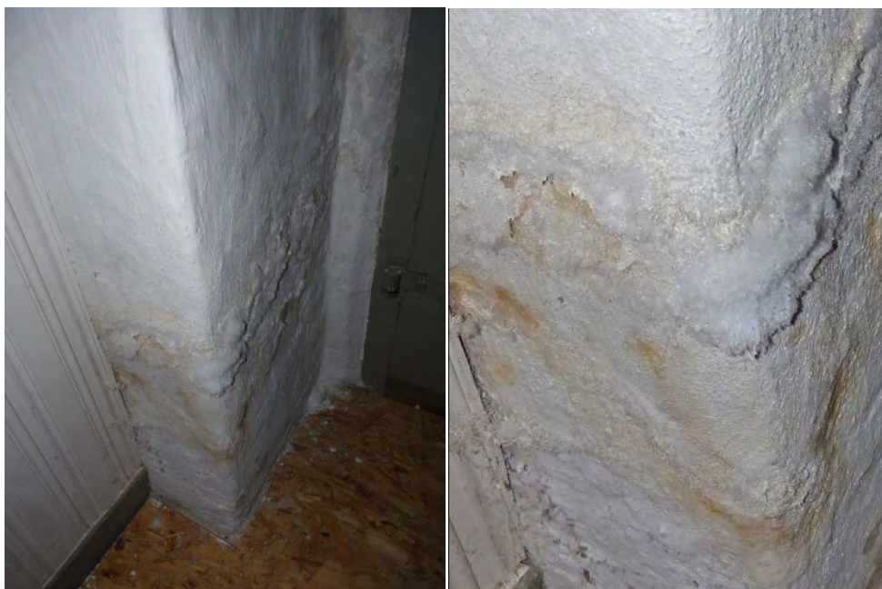
Figur 51. Saltutfällningar och gulning på grund av stora fukt mängder söder om porten i västra vapenhuset efter en första omputsning.
