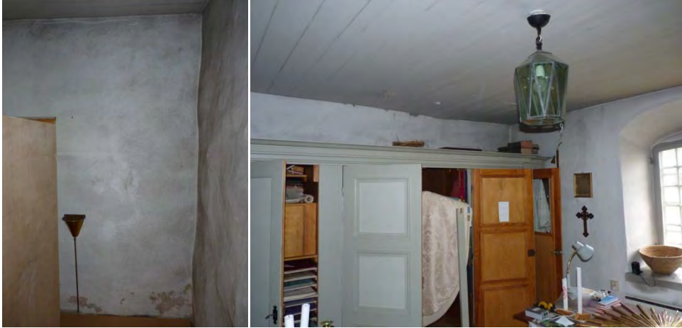
Figur 45. Sakristian nordöstra hörnet före åtgärder.
