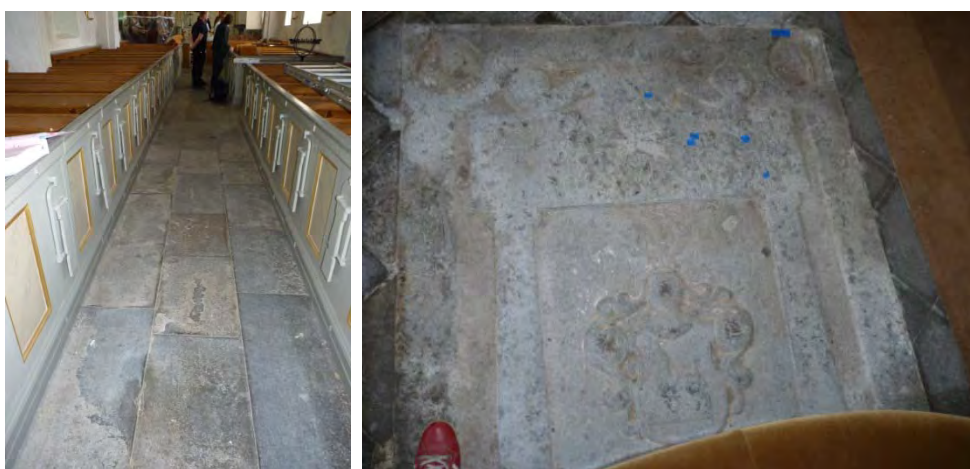
Figur 73. Kalkstensgolv i mittgång inte åtgärdat.
