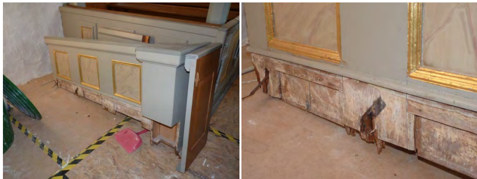
Figur 127. Den nedre delen av bänkskärmen, som var mest rötskadad, är borttagen.
