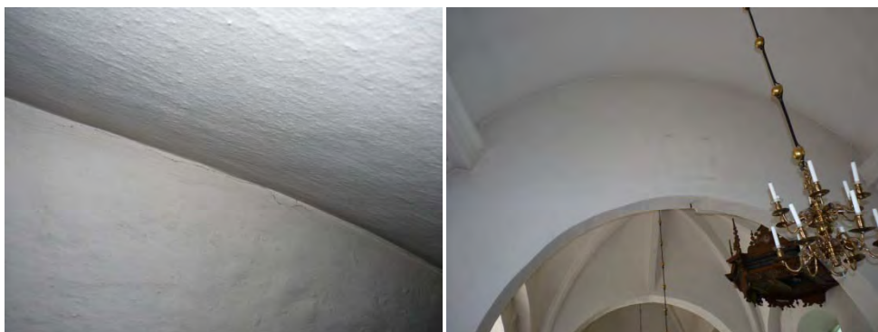
Figur 13. Tunnvalvet är sedan 1980-talet täckt med microlite. Tunnvalvet sett mot öster. Mindre spricka i anslutningen mellan vägg och valv.
