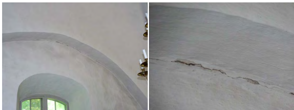
Figur 32. Spricka över fönster norrvägg.
