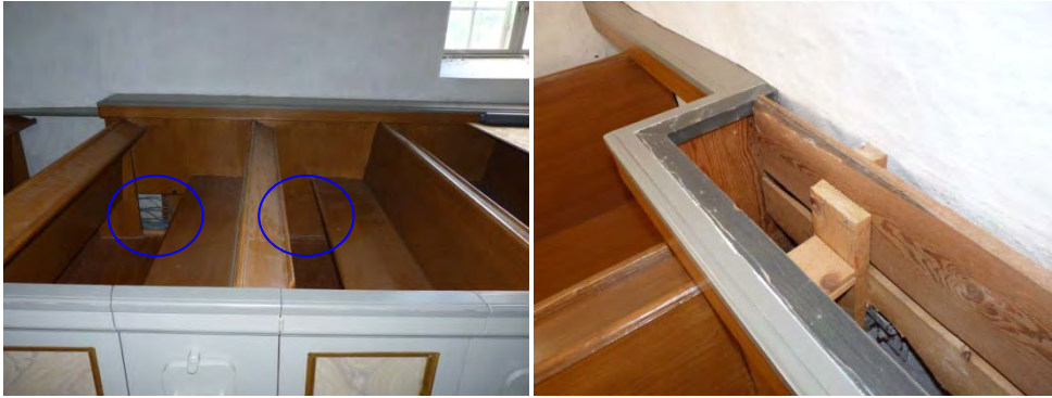
Figur 131. Befintliga luckor i bröstningen före åtgärd.
