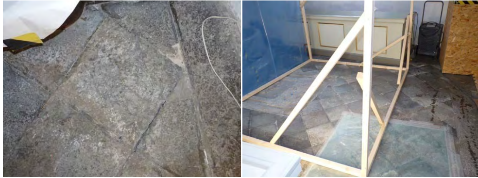
Figur 77. Sten i nordväst med vittringsskador. Frisen lyftes upp men behölls. Kalkstensplattor byttes. Figur 78. Korgolvet sett mot söder.
