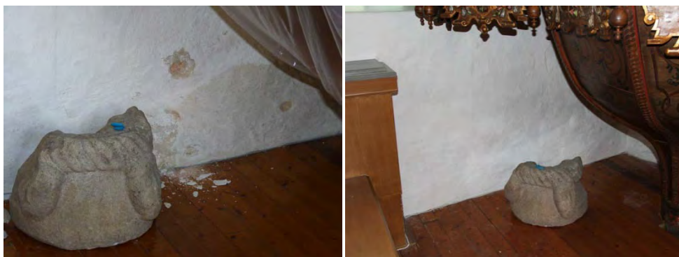
Figur 18. Under predikstolen fanns före åtgärderna putsbortfall och troligen salter i väggen.
