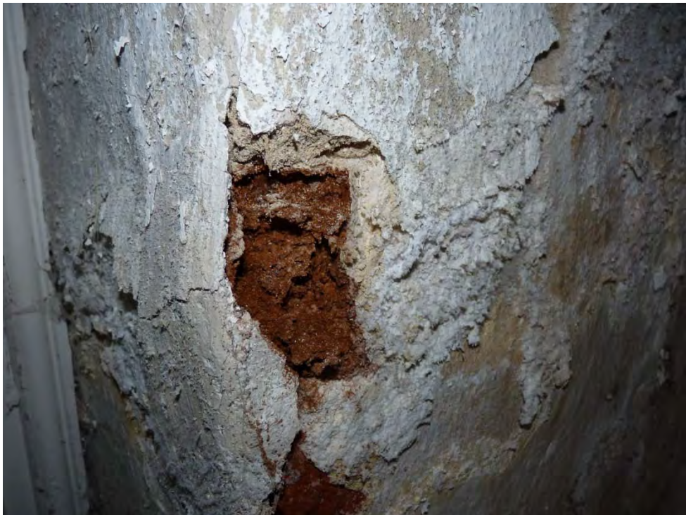
Figur 50. Poröst tegel och saltproblematik före åtgärder.
