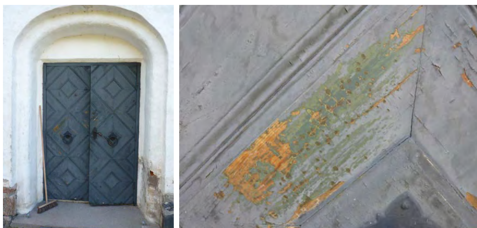
Figur 54. Västra vapenbusdörren före åtgärder.
