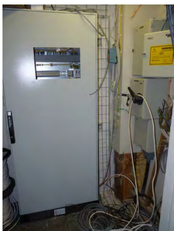
Figur 99. Nytt styrskåp på plats mot norra väggen.
