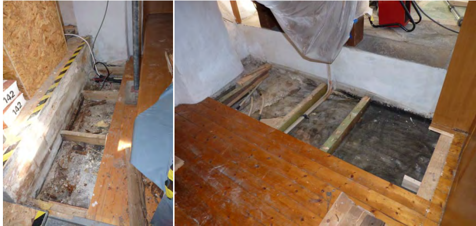
Figur 85. Golvet upptaget längst fram i södra bänkkvarteret. Hög fuktighet uppmättes i bjälkar och virke som tidigare låg direkt mot betong och var helt rötskadat. Figur 86. Golvet i norra bänkkvarteret upptaget.
