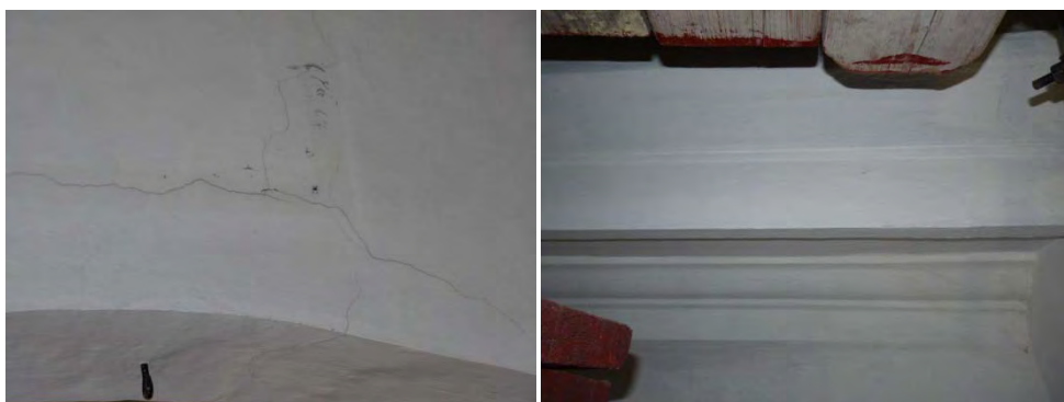
Figur 15. Spricka i valvbågen mot väster.
