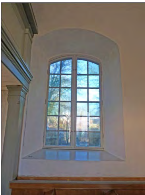
Figur 69. Ommålade fönsterbågar och fönsterbänk.
