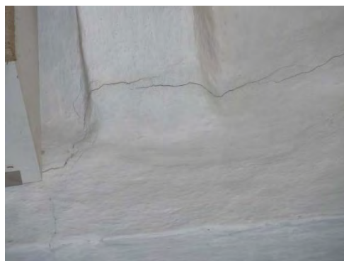
Figur 24. Spricka vid högtalare före åtgärd.
