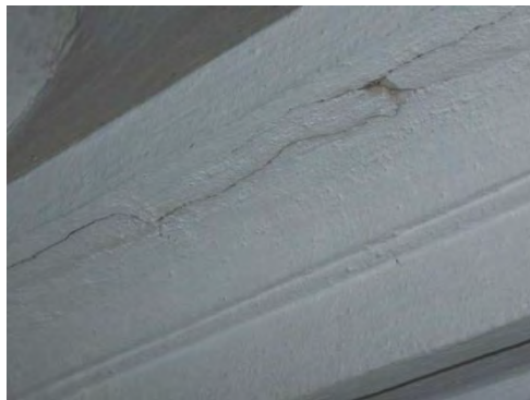
Figur 39. Spricka i tunnvalvets listverk, norra sidan.
