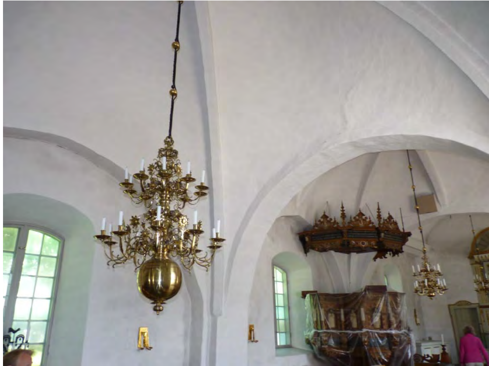
Figur 29. Spricka och bomputs i valv mot öster.
