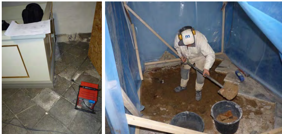
Figur 79. Kalkstensplattorna i korets sydvästra del är generellt i bättre skick. Någon enstaka är vittrad. Längst mot väggen ansas den kalkstensplatta i frisen som lyfts för att komma åt de befintliga kabeldragningarna till vaktmästarrummet. Figur 80. Urschaktning i korets nordvästra del.
