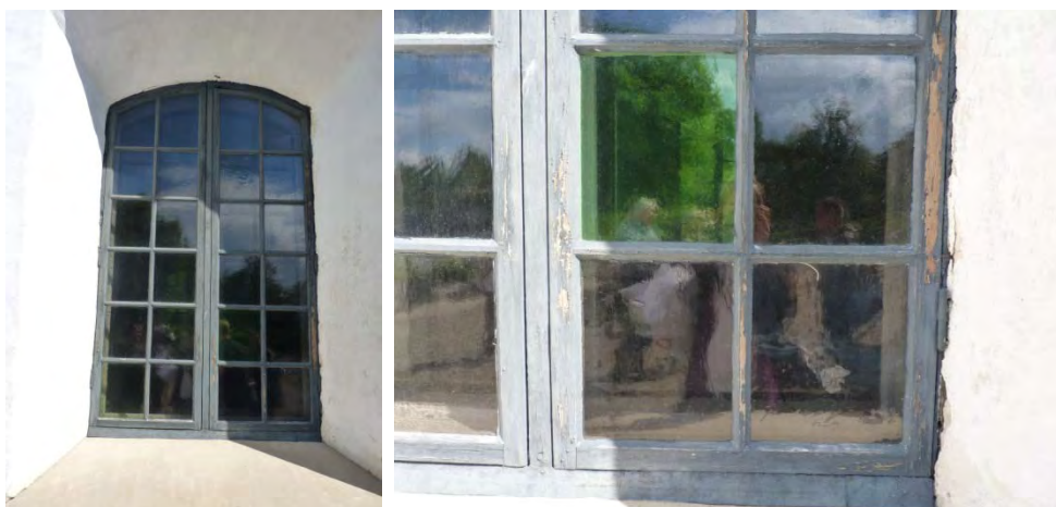
Figur 60. Västra fönstret på södra fasaden före åtgärder.
