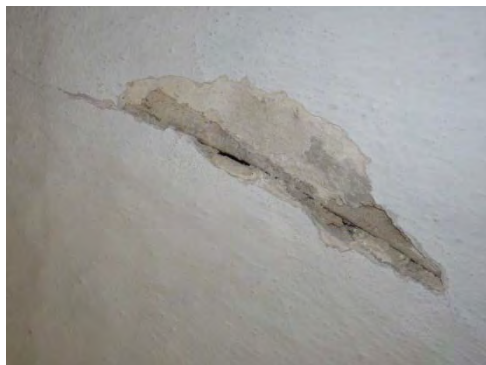
Figur 43. Spricka över sydfönster före åtgärd.
