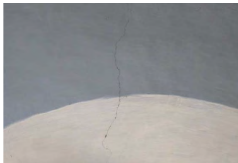
Figur 22. Spricka över sydfönster före åtgärd.
