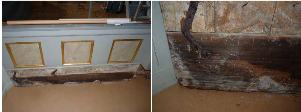
Figur 125. Södra bänkskärmen med rötskadat nedre parti.
