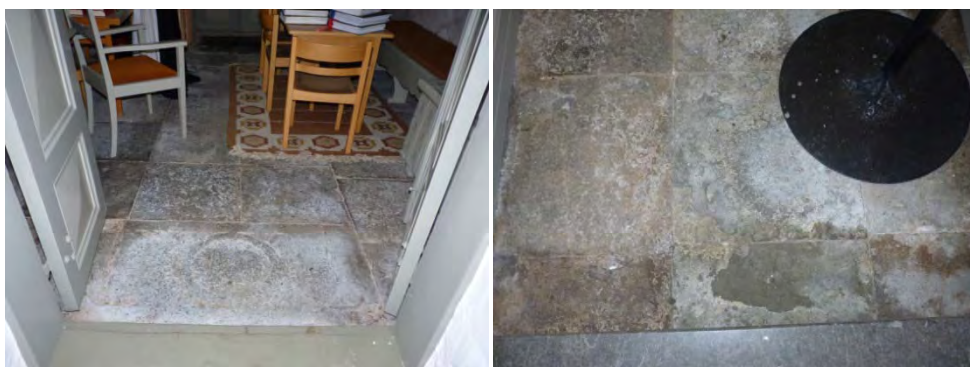
Figur 71. Kalkstensgolv delvis vittrat, men ej åtgärdat, i södra vapenhuset.
