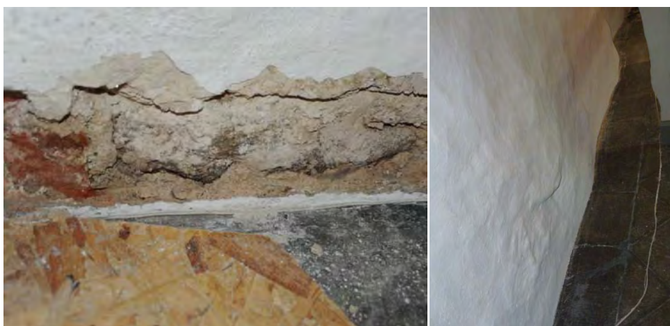
Figur 122. Uppbilat parti i nederkant av putsen på korets södra vägg. Spår av befintlig kabel i bildens vänstra del. Foto: Svensk klimatsstyrning.
