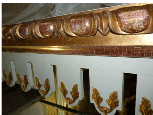
Figur 105. Skador på äggstavslisten på altaruppsatsens baldakin. Den röda grunden för polimentförgyllningen skyntar igenom. Åtgärdades ej utöver rengöring.
